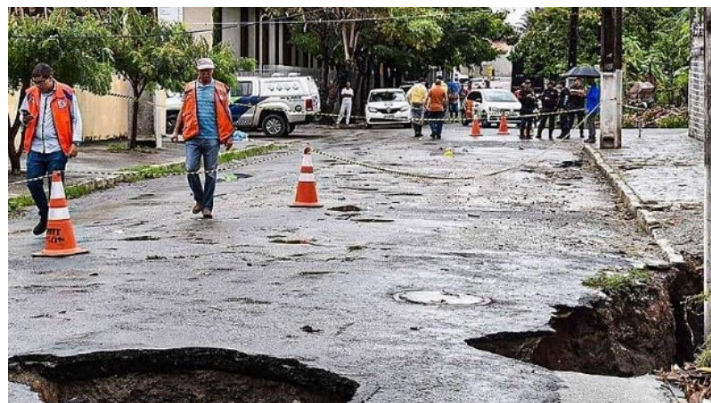
FIGURA 5. INSTABILIDADE DO SOLO NOS BAIRROS QUE SOFRERAM POR CAUSA DA EXTRAÇÃO DO MINEIRO SAL-GEMA.
