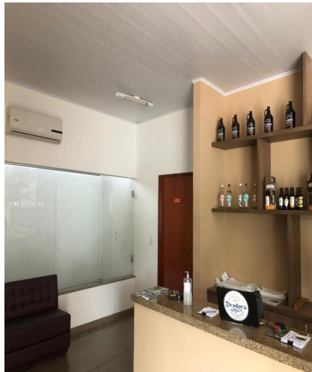
Figura 5 – Equipamentos de refrigeração e iluminação da loja.
