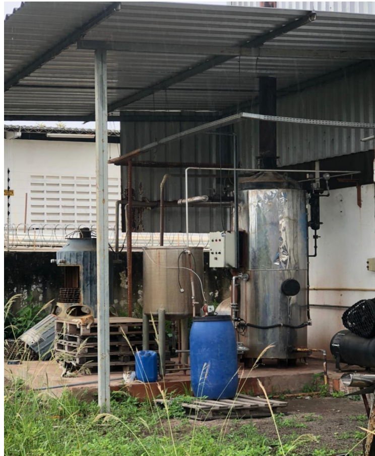
Figura 7 – Caldeira para aquecimento do mosto
