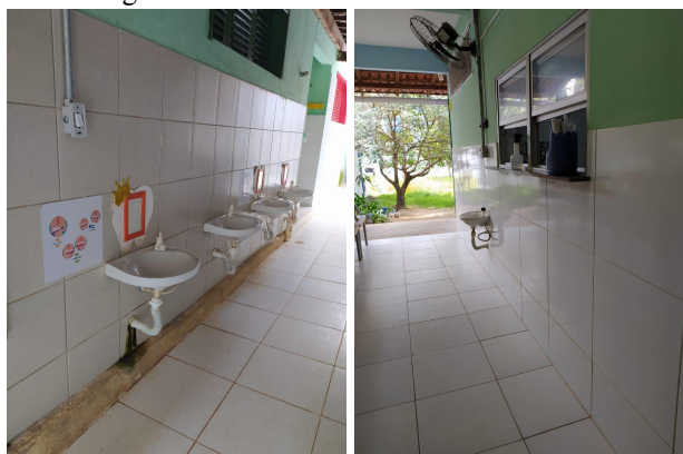
Figura 60: Lavatórios existentes na escola.
