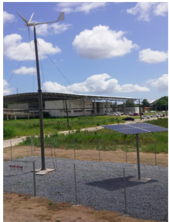
(b) Painéis fotovoltaicos
