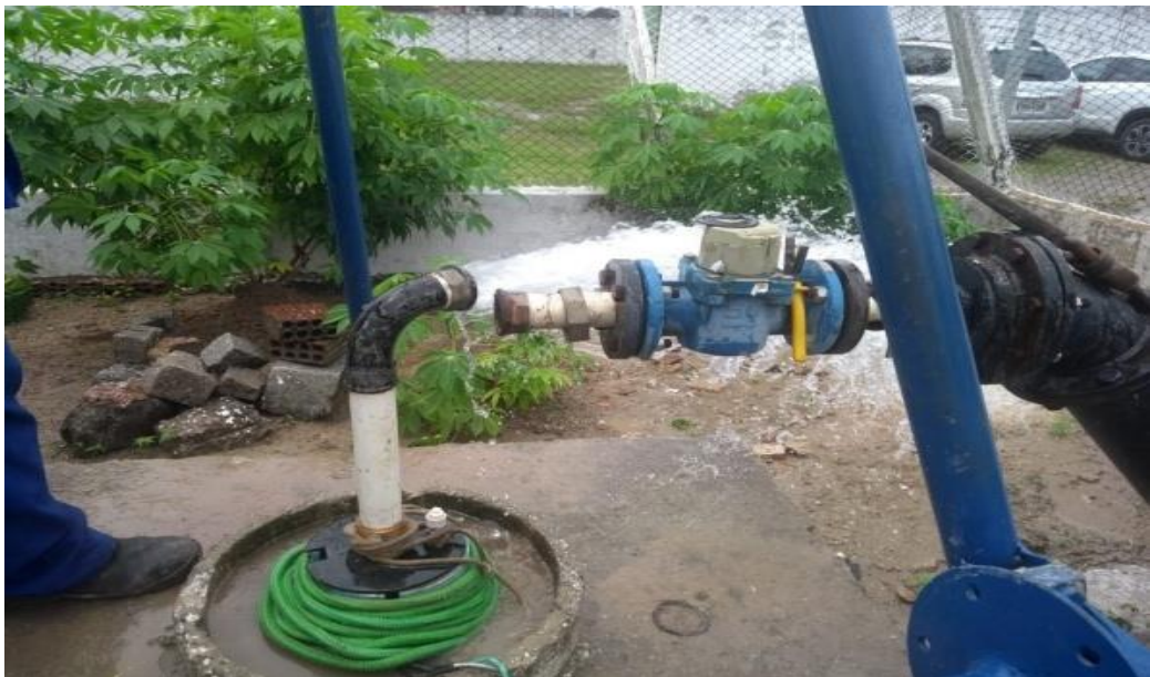
Figura 7- Bomba do poço artesiano que integra os sistemas de abastecimento.
