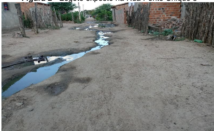
Figura 2 - Esgoto exposto na Rua Ponto Chique 3
