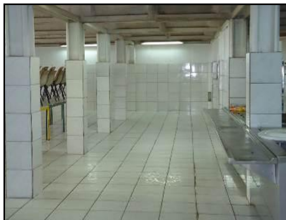
Figura 4.62 – Ausência de piso alerta nos pilares
