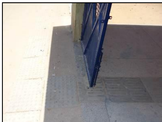
Figura 4.6 – Obstrução do piso tátil
