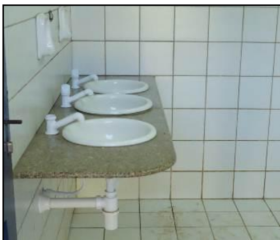
Figura 4.36 – Torneira tipo bola no lavatório
