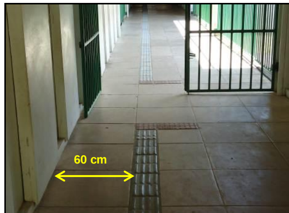
Figura 4.52 – Piso tátil no corredor do pav. Térreo
