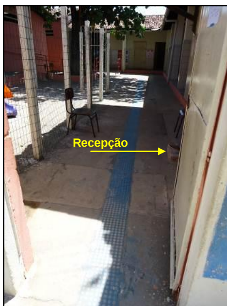
Figura 4.91 – Piso tátil na entrada
