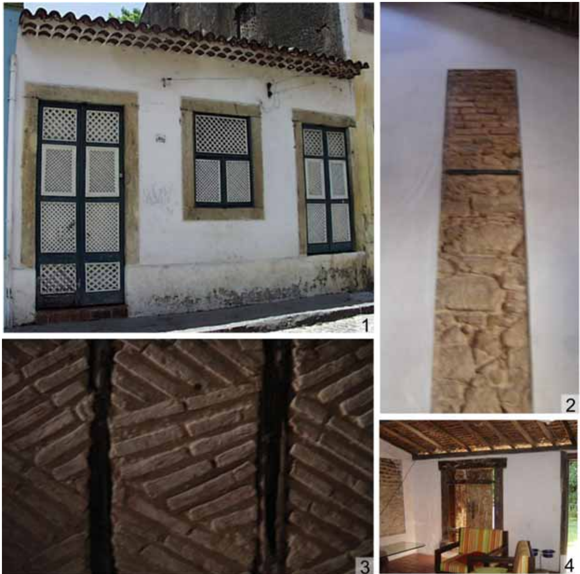
Figura 80 – Fachada da casa n. 165, Rua do Amparo (1). Prospecção na parede da sala (2), e nas paredes internas (3). Coberta, parede e umbrais das portas de fundos (4). Fonte: Prefeitura Municipal de Olinda (foto 1) e Arquivo pessoal (foto 2, 3, 4).
