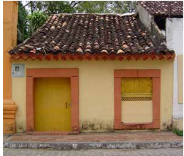
Figura 79 – Casa n. 252 na Rua do Bom Sucesso, Olinda.
