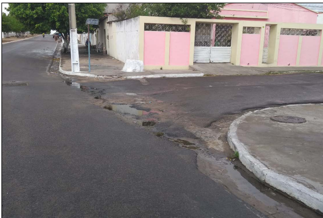
Figura 11 - Erosão causada por falta de dispositivo de microdrenagem
