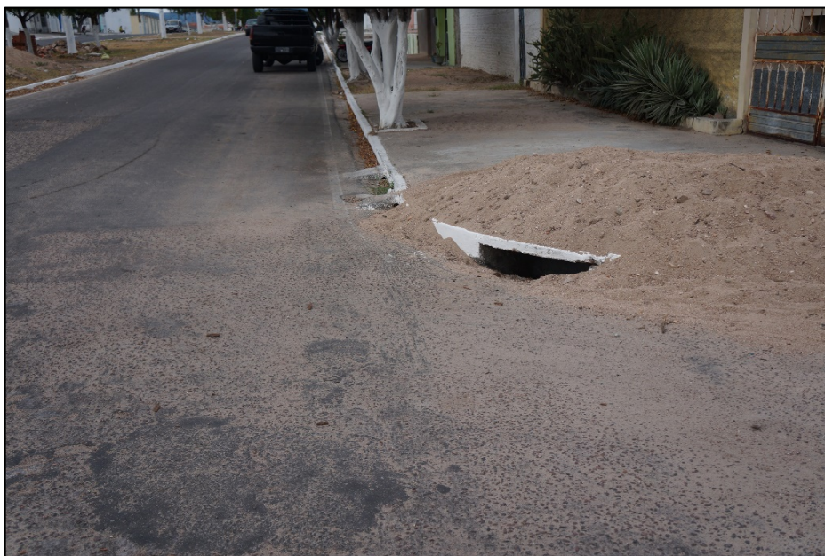
Figura 12 - Uso indevido de boca de lobo
