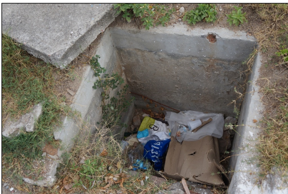
Figura 13 - Acúmulo de lixo na boca de lobo
