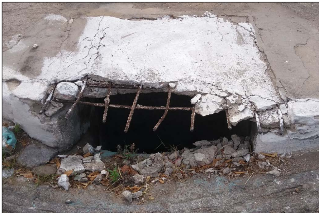
Figura 14 - Falta de manutenção nos dispositivos de microdrenagem
