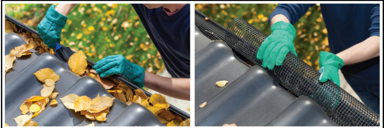
Figura 2 – Proteção de calhas para evitar acúmulo de detritos
