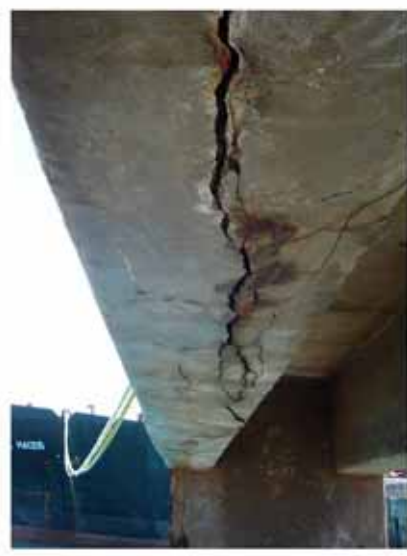
Figura 2 – Fissura em viga do píer da Braskem.
