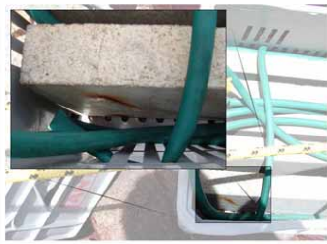
Figura 37 – Ponto de corrosão em placa com sílica aos 41 dias.
