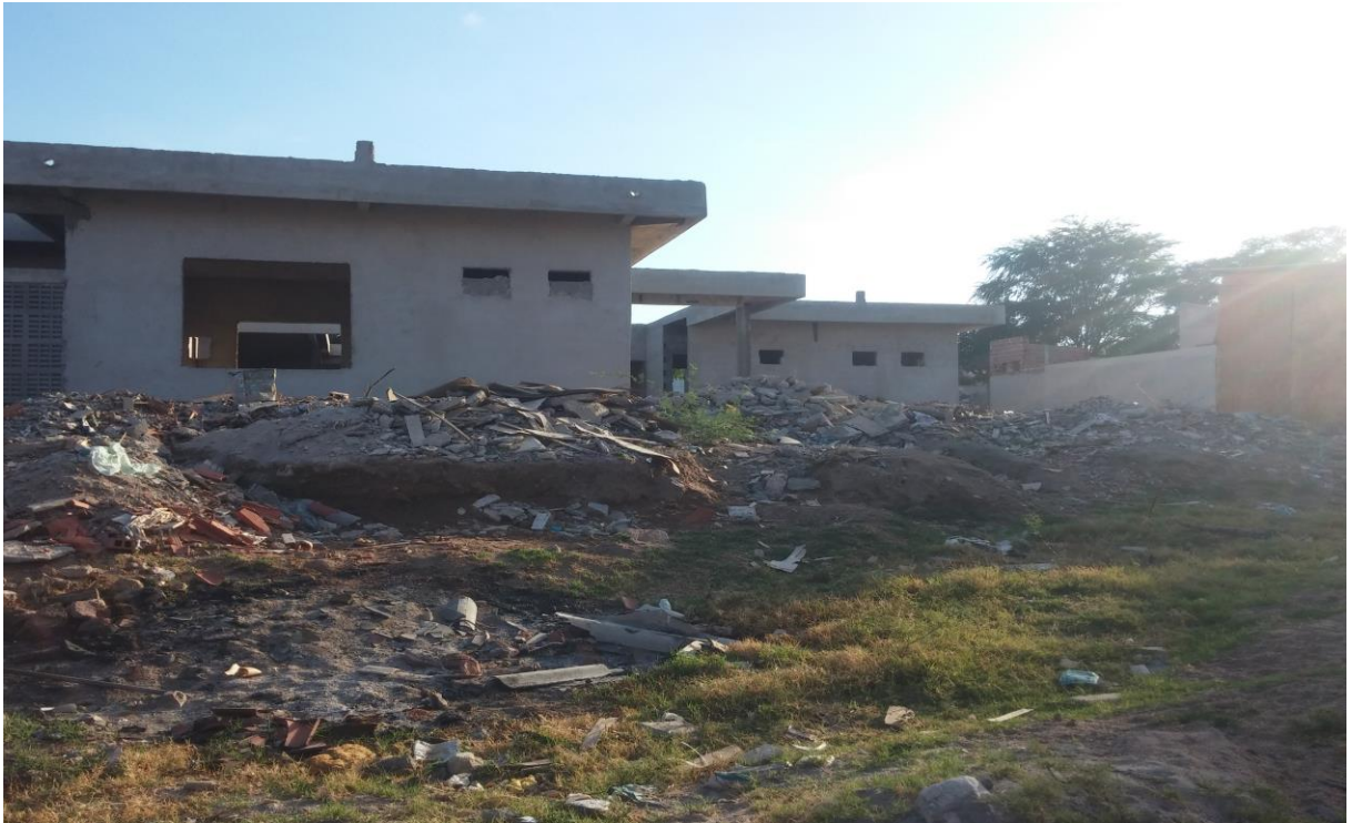
Figura 7: Desorganização dentro do canteiro
