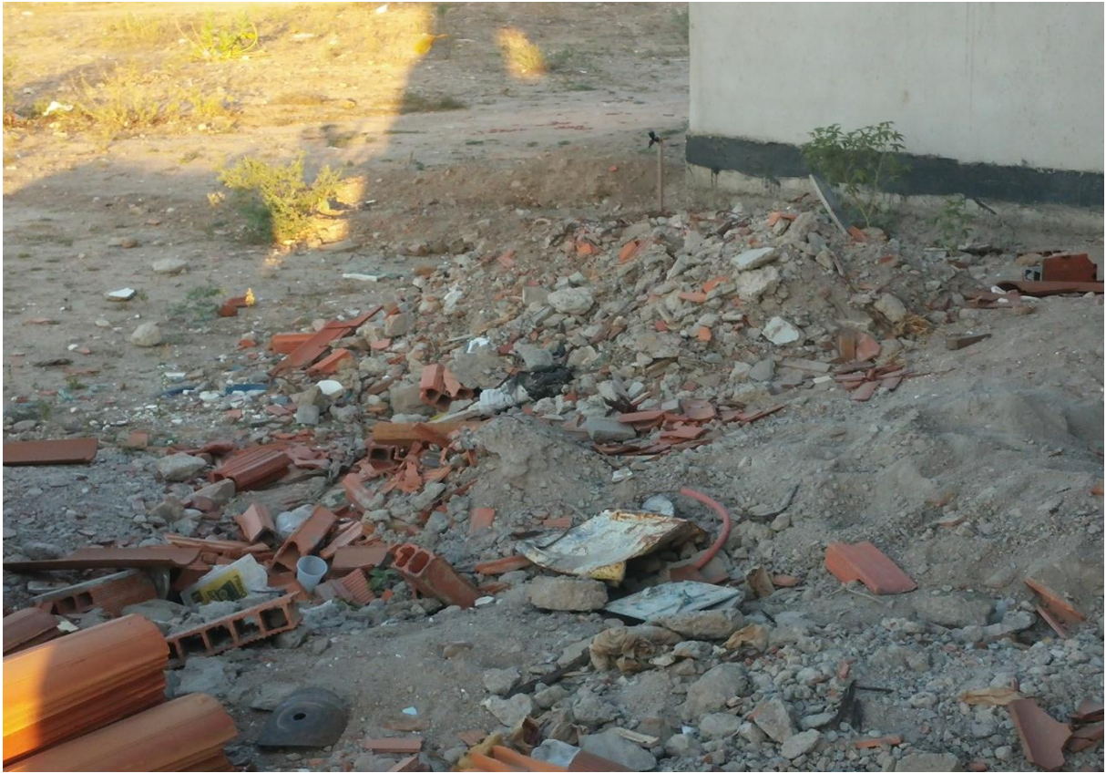
Figura 10: Ausência da segregação e triagem dos resíduos gerados
