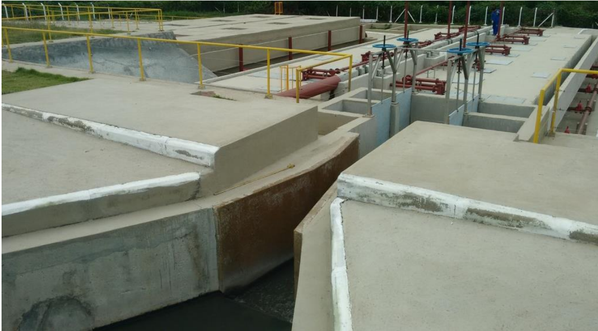
Figura 6 - Calha Parshall, ETE 01 - Centro.
