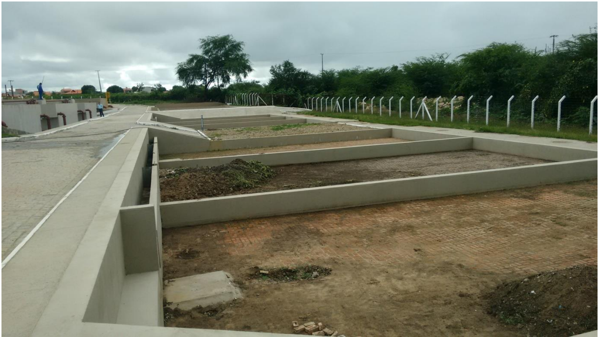
Figura 8 – Leitos de secagem, ETE 01 – CENTRO.
