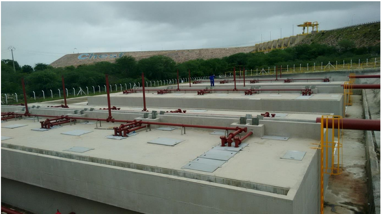
Figura 7 - Reatores anaeróbios de fluxo ascendente, ETE 01 - Centro.
