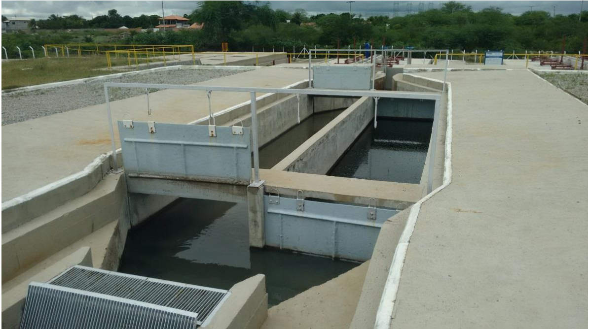
Figura 5 - Desarenadores, ETE 01 - Centro.
