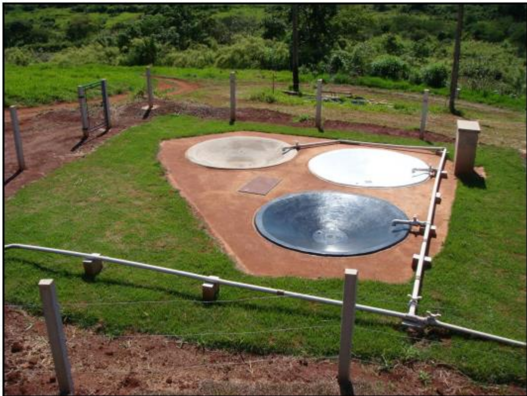
Figura 6: Sistema de desinfecção solar.
