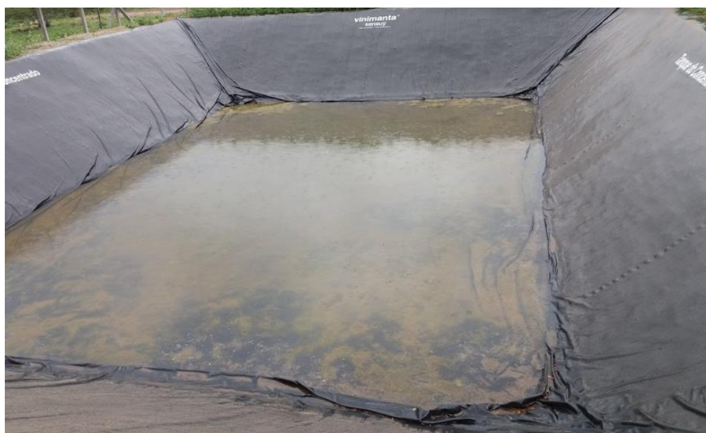
Figura 11: Projeto para decimização de água (ainda sem funcionamento).
