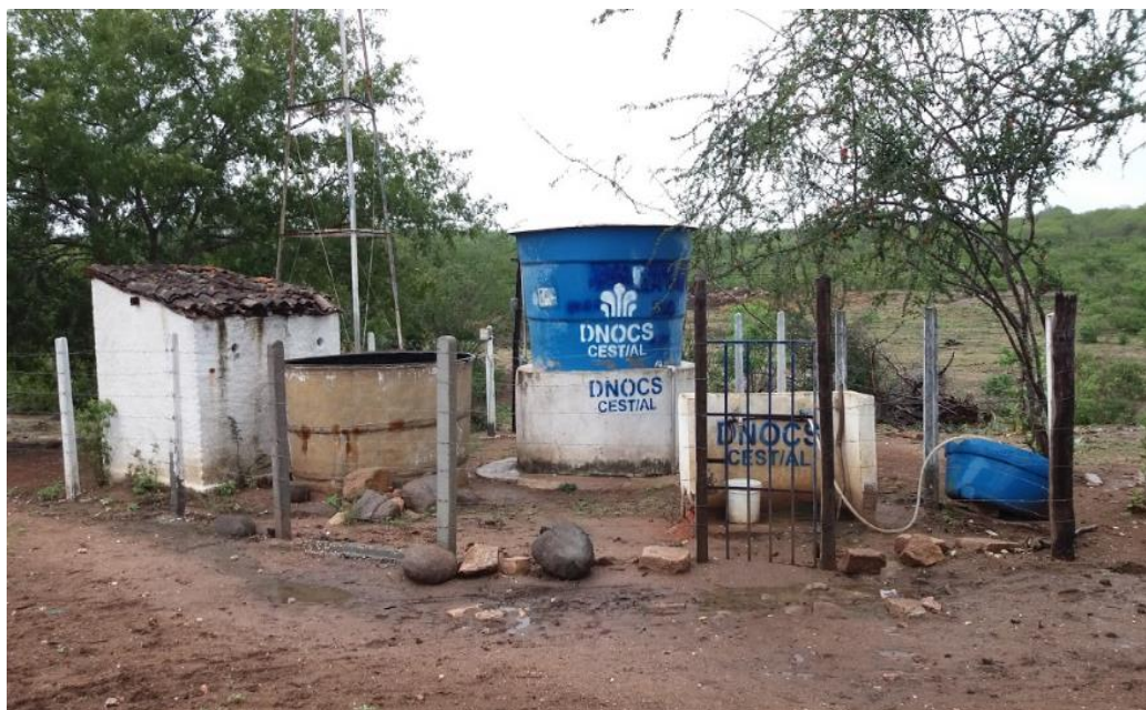
Figura 5 – POÇO ARTESIANO COMUNITÁRIO.
