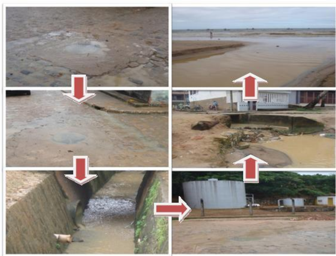
Figura 52: Esgoto a céu aberto no Conjunto Habitacional Adélia Lira (Grotá) desde o vazamento no poço de visitas, passando pela rede de drenagem urbana até o mar
