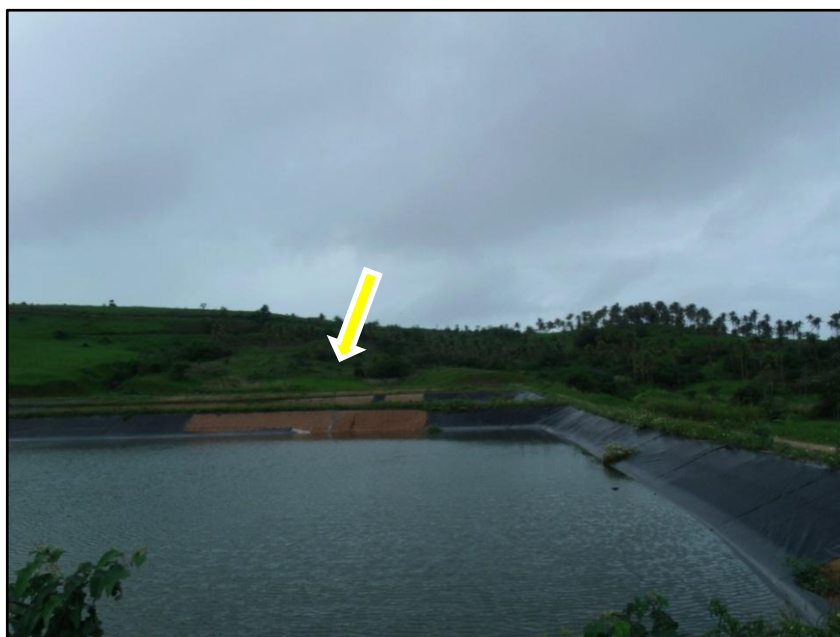
Figura 69: Problema na impermeabilização da lagoa de estabilização na ETE de Maragogi
