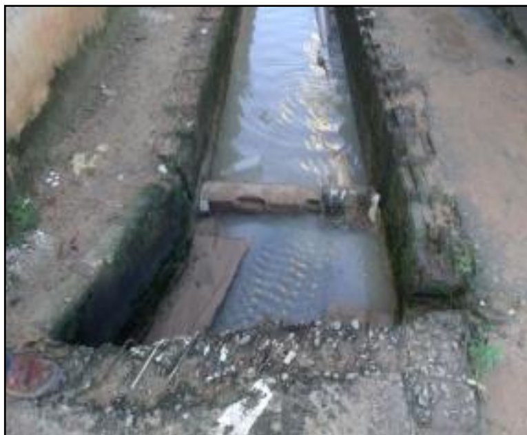
Figura 50: Galeria de águas pluviais do conjunto habitacional Adélia Lira em seu trecho final próximo ao mar
