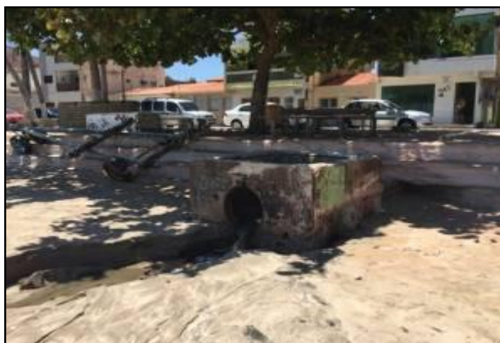
Figura 47: Extravasamento da rede de esgotos na orla da área central de Maragogi - orla marítima
