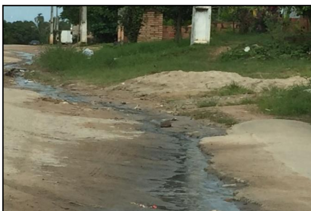
Figura 35: Esgoto correndo a céu aberto as margens da AL-101-Norte - Barra Grande
