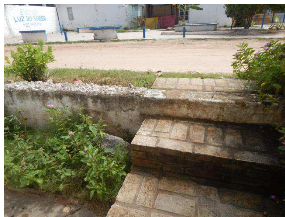
Figura 68- Desnível entre a rua e a entrada da Casa da Arte.
