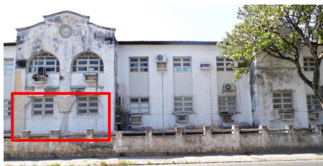
Figura 39- Fachada principal da antiga LBA. Em destaque fechamento de vãos com alvenaria.
