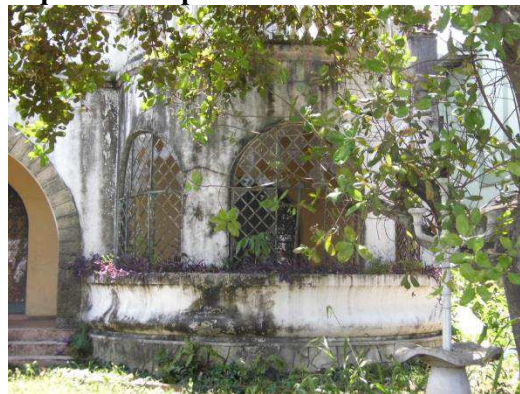
Figura 70- Residência 415 com esquadrias depredadas.
