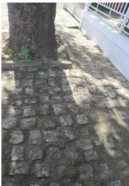
Figura 14. Terminalia Catappa L na rua Des. Barreto Cardoso plantada fora da área de serviço, suas raízes danifica.
