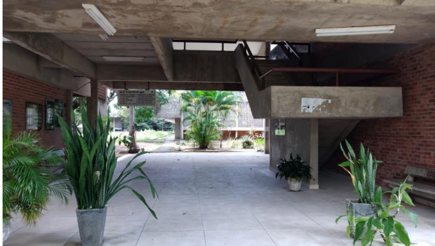
Figura 16 – Acesso principal da FOUFAL com sinalização visual deficiente.
