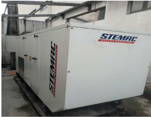
Figura 8 - Gerador à Óleo Diesel. Modelo: GMG 180KVA 380V 60HZ 3F
