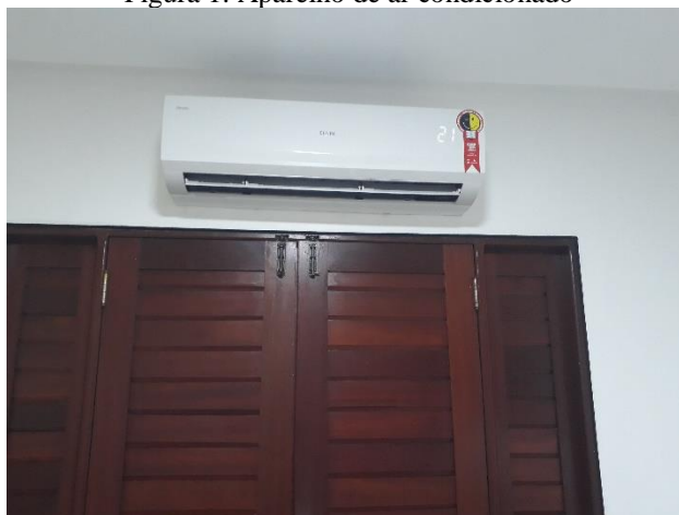
Figura 1: Aparelho de ar condicionado
