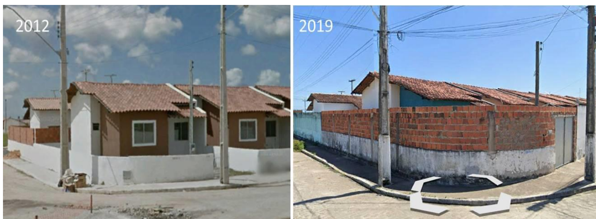
Figura 14 - Descaracterização de uma das unidades habitacionais no empreendimento
