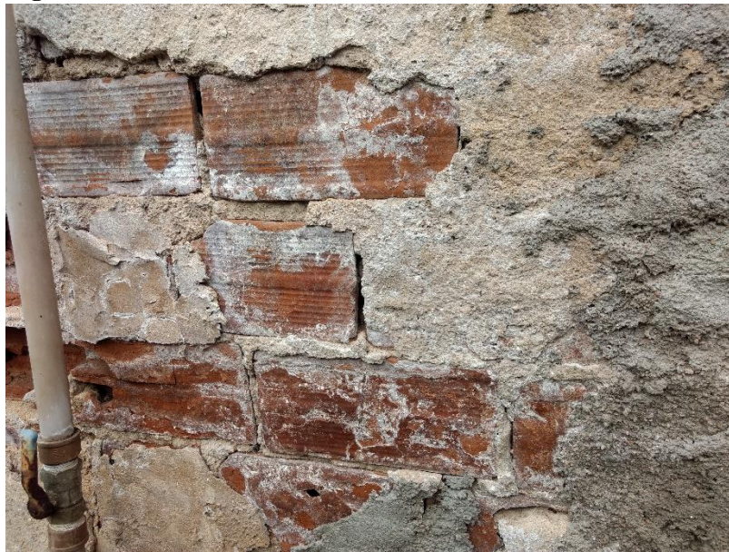
Figura 2.2 - Subflorescência na alvenaria.
