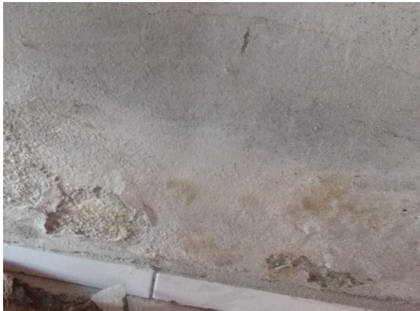
Figura 2.1- Eflorescência na alvenaria
