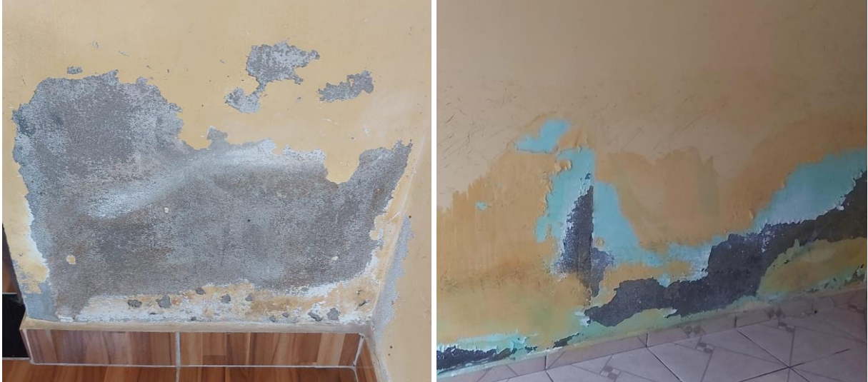
Figura 4.8 - Paredes com descamação da tinta e indícios de eflorescência.
