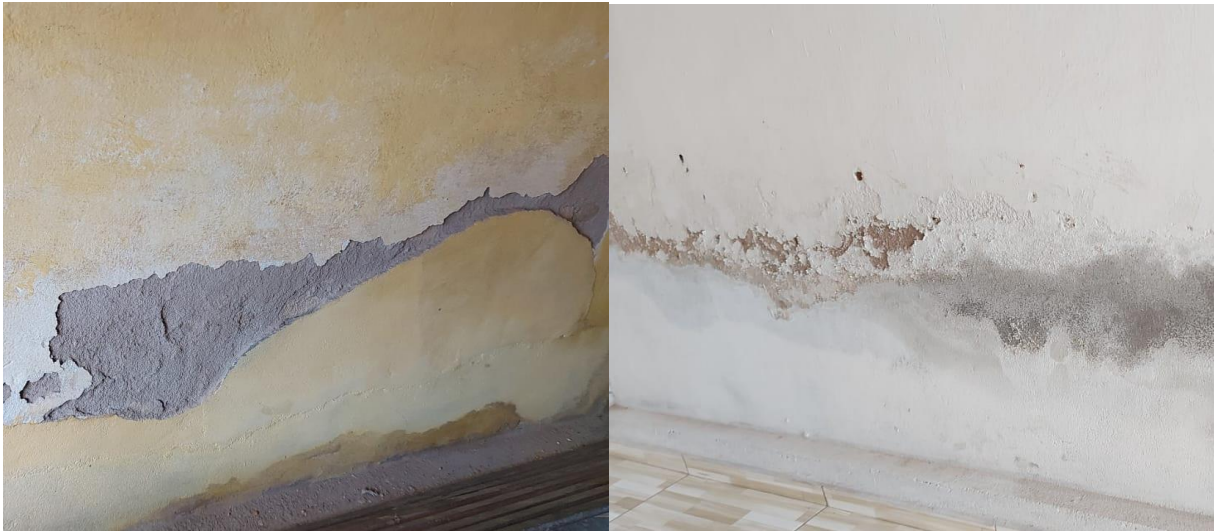
Figura 4.9 - Paredes com indícios de eflorescência.
