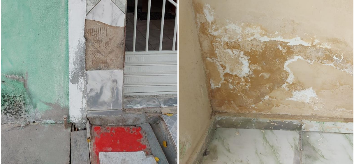
Figura 4.11 - Revestimento cerâmico com manchas.
