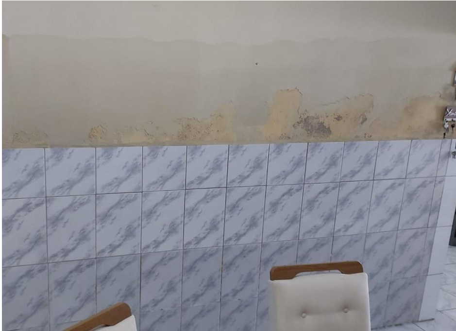
Figura 4.10 - Parede com revestimento cerâmico com muita umidade.
