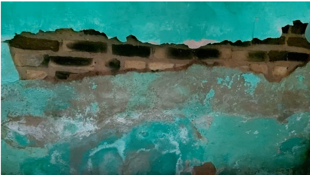
Figura 4.12 - Parede em avançado estado de deterioração.
