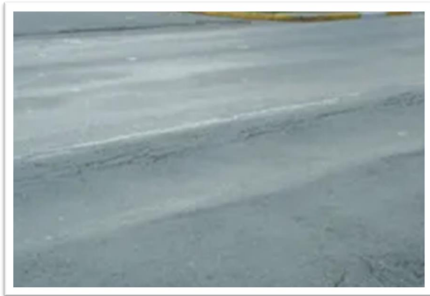
Figura 5 - Afundamento por consolidação
