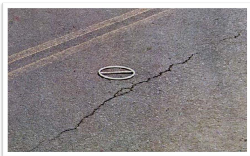
Figura 3- Trinca isolada – longitudinal
