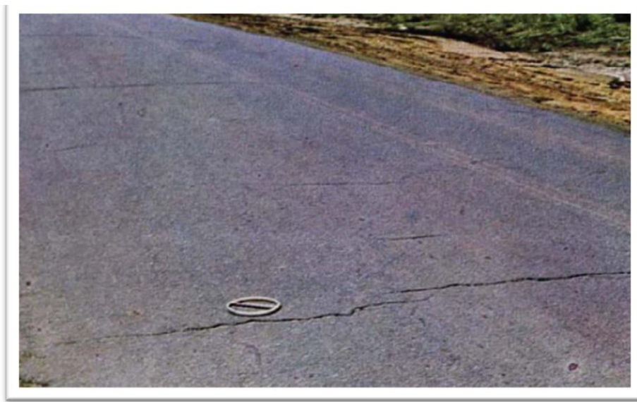
Figura 2- Trinca isolada – transversal
