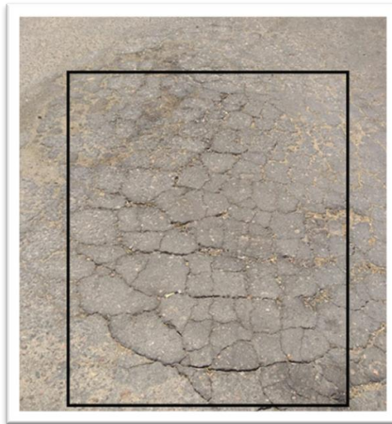
Figura 22 - Trincas Interligadas tipo couro de jacaré
