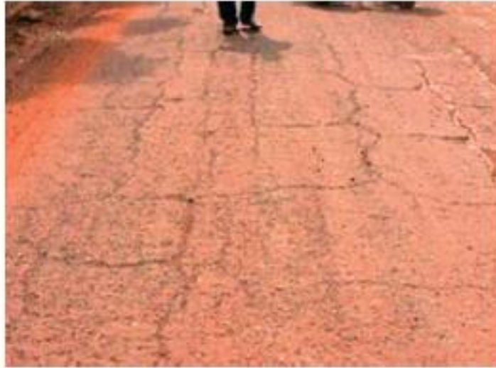
Figura 9: Trinca Tipo bloco.
