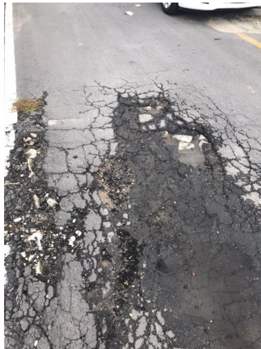
Figura 33: Patologia, tipo panela ou buraco, localizada na rua Campos Sales.
