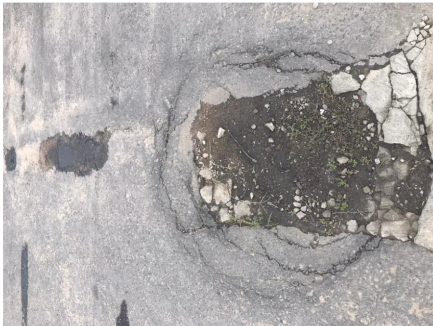
Figura 41: Patologia, tipo afundamento de consolidação, localizada na Avenida Campos Sales.
