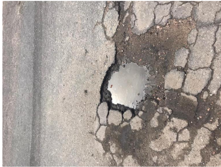
Figura 34: Patologia, tipo panela ou buraco, localizada na Avenida Beira Rio.
