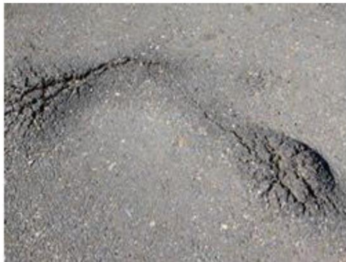
Figura 12: Afundamento plástico local.
