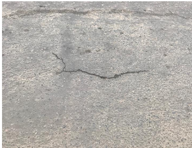
Figura 36: Patologia, tipo trinca longitudinal, na Avenida Moxotó.
