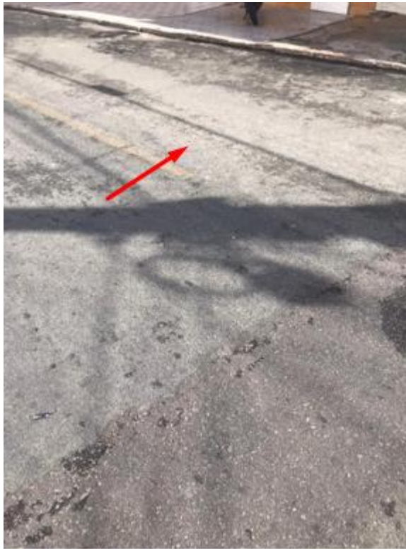
Figura 31: Patologia, tipo ondulação ou corrugação, localizada na Avenida Getúlio Vargas.
