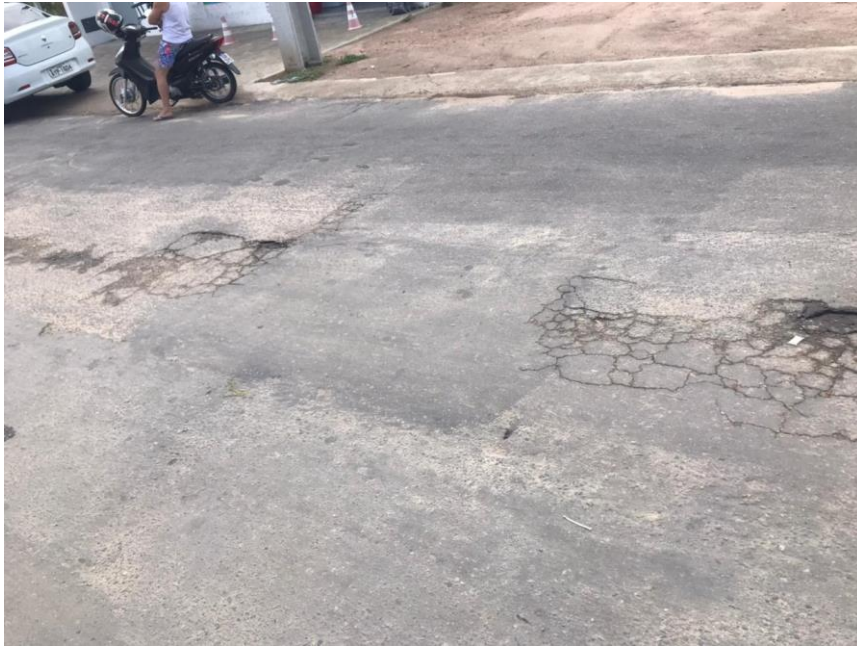
Figura 42: Patologia, trincas tipo couro de jacaré, localizada na Avenida Moxotó.
