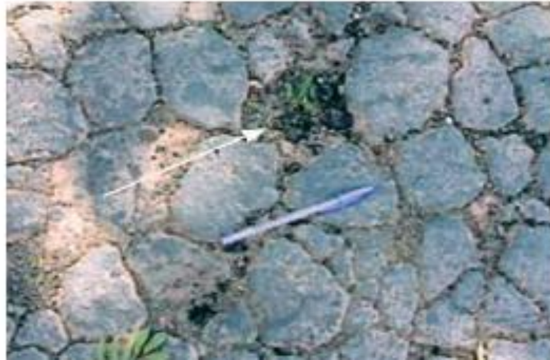
Figura 8: Trinca Tipo couro de jacaré.
