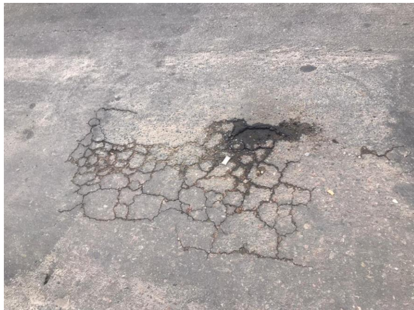
Figura 35: Patologia, tipo panela ou buraco, localizada na Avenida do Aeroporto.
