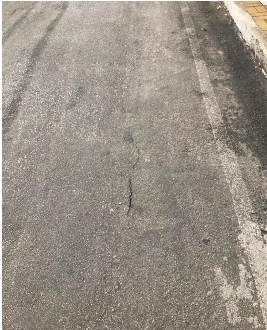
Figura 37: Patologia, tipo trinca longitudinal, na Avenida Getúlio Vargas.
