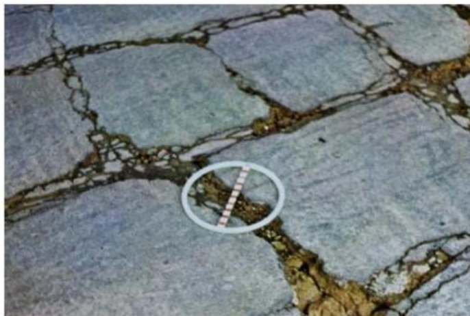
Figura 10: Trinca Tipo bloco.
