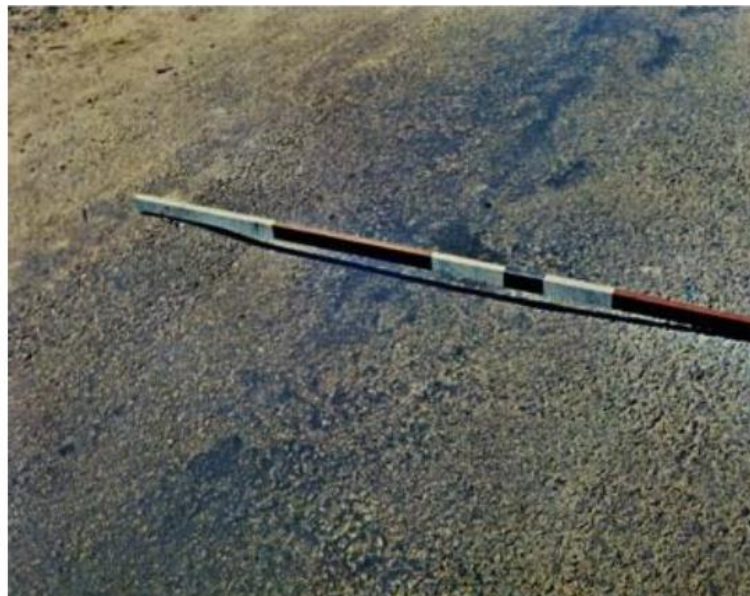
Figura 14: Afundamento de consolidação.
