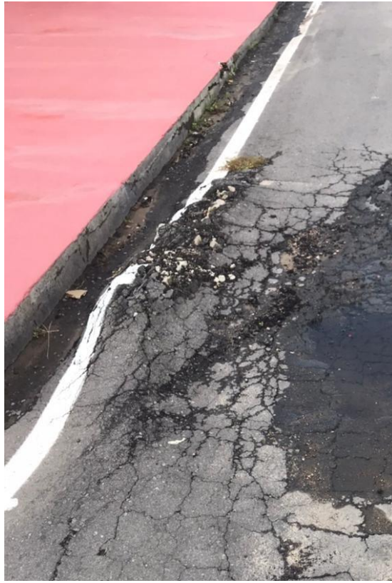
Figura 38: Patologia, tipo escorregamento, localizada na Rua Campos Sales.
