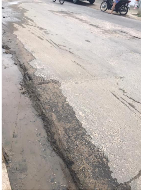
Figura 39: Patologia tipo remendo, localizada na Avenida Moxotó.
