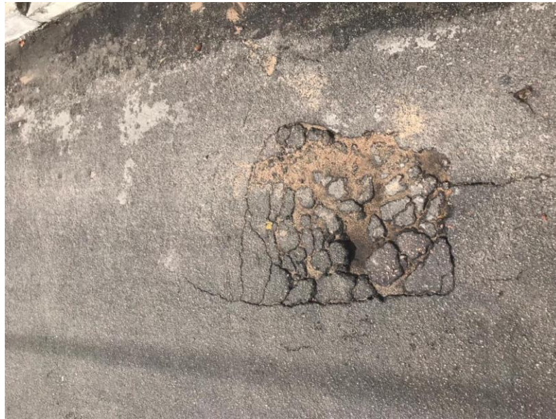
Figura 32: Patologia, tipo panela ou buraco, localizada na Avenida Getúlio Vargas.
