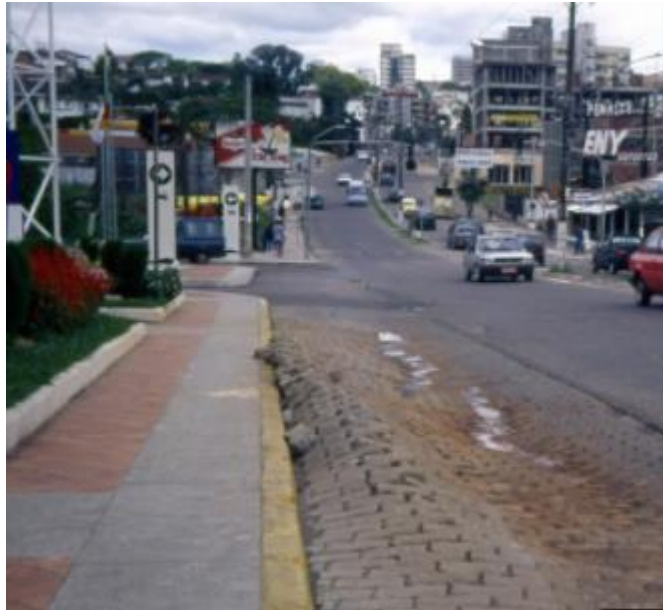
Figura 3: Ruptura por resistência.
