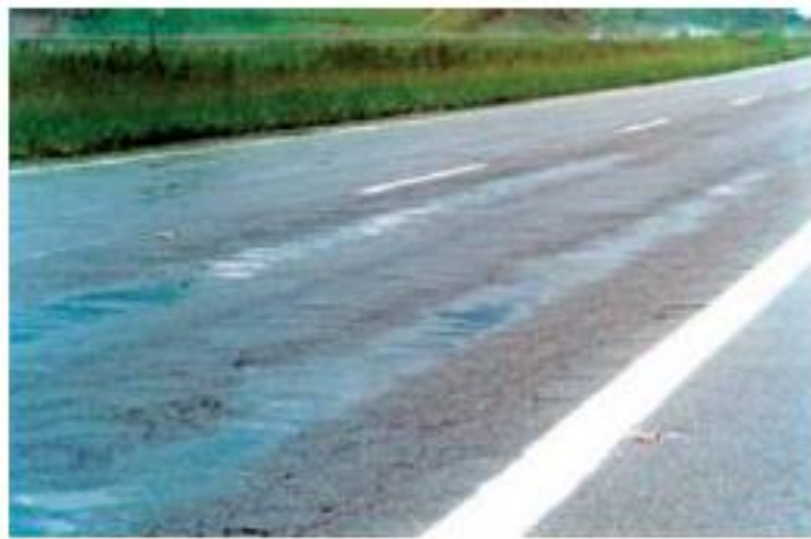
Figura 13: Afundamento de consolidação.
