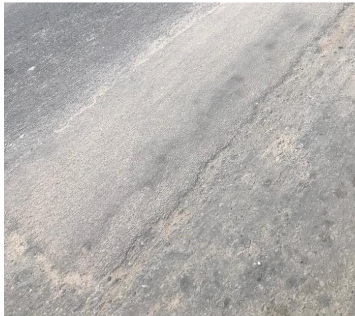
Figura 40: Patologia tipo remendo, localizada na Avenida do Aeroporto.
