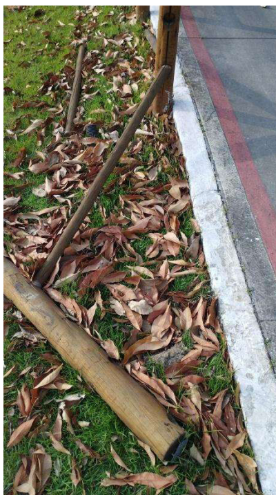
Figura 12 – avaria nos guarda-corpos de madeira
