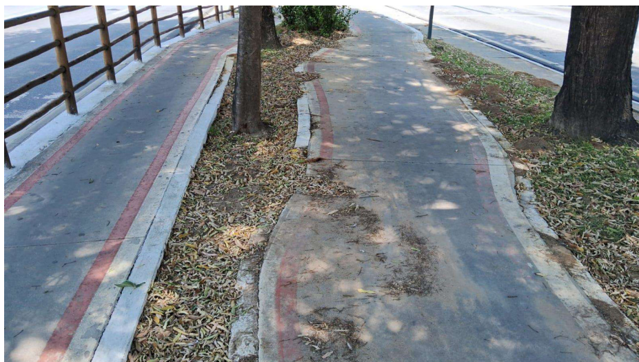
Figura 18 – Possível rebaixamento do solo acrescido da falta de meio fio.
