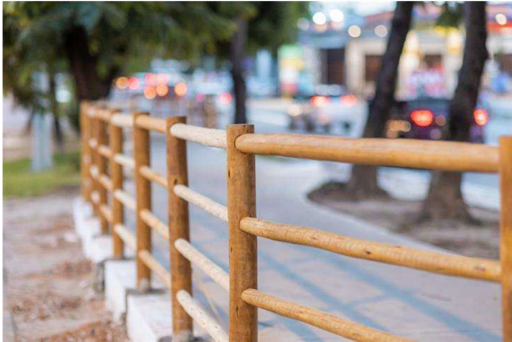
Figura 09 – Equipamentos de proteção de madeira em estado de novo.
