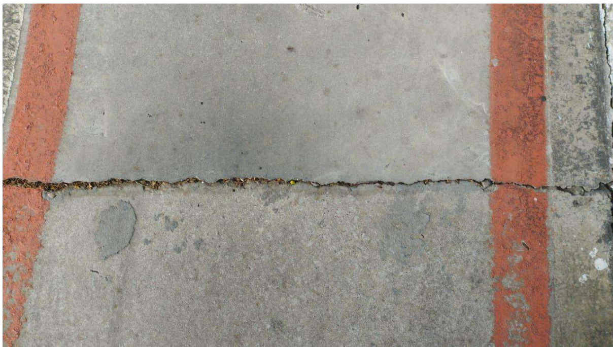
Figura 43 – Fissura por falta de junta de dilatação.
