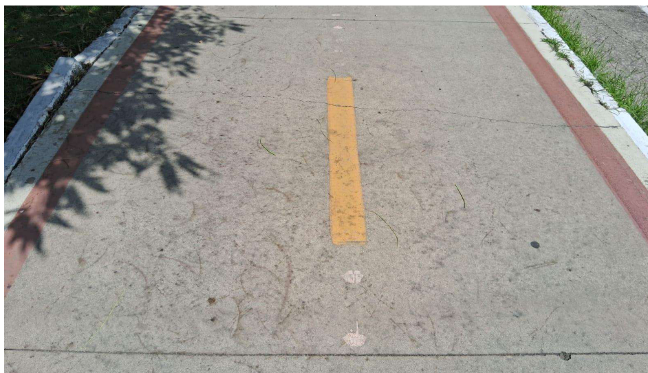
Figura 13 – Fissuras e movimentação de meio-fio, possivelmente causado por raízes de árvores.
