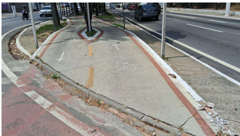
Figura 29 – Fissura de canto.
