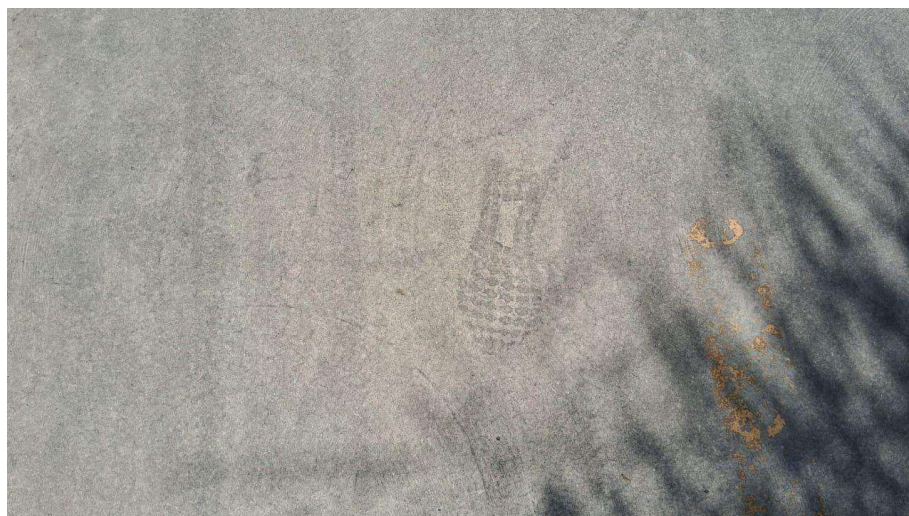
Figura 24 – Mau acabamento da placa de concreto, tempo de pega não respeitado.
