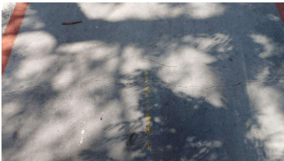
Figura 36 – Fissuras por não respeitar o tempo de cura.
