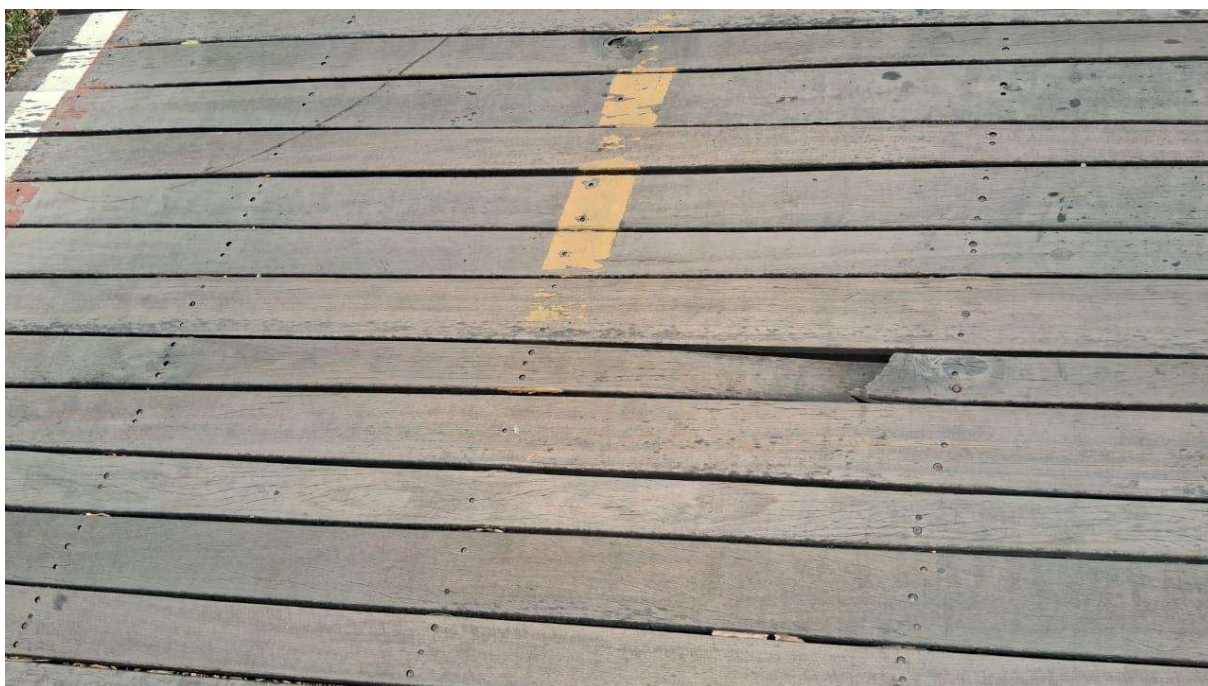
Figura 57 – Fissuras em estruturas de madeira.
