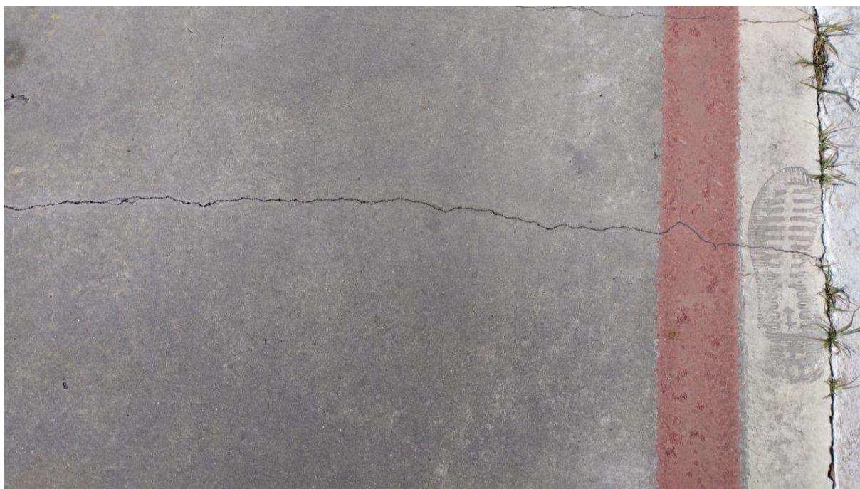
Figura 44 – Fissura transversal e pega do concreto não respeitada.
