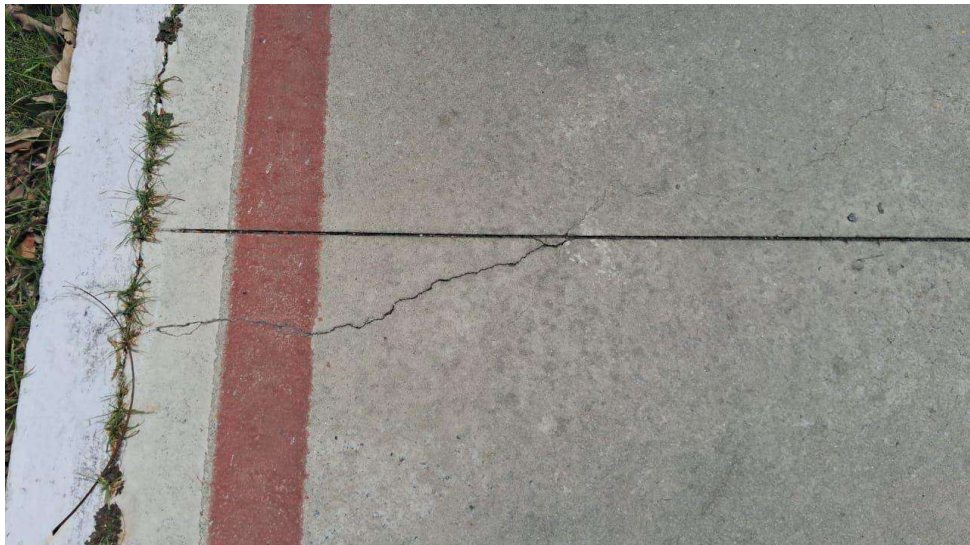
Figura 31 – Fissura de ponta.
