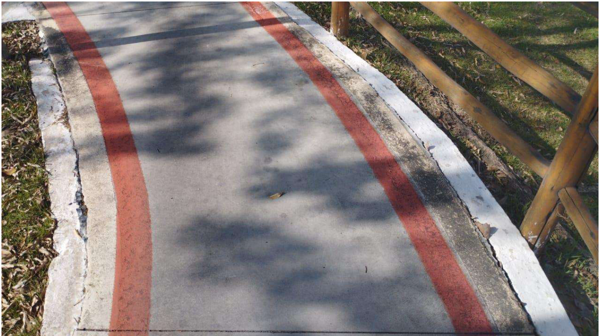
Figura 46 – Meio fio quebrado.
