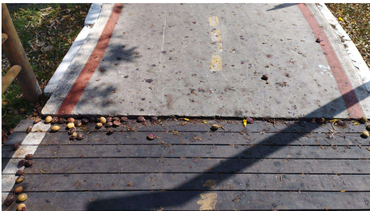
Figura 37 – Afundamento do piso de madeira.
