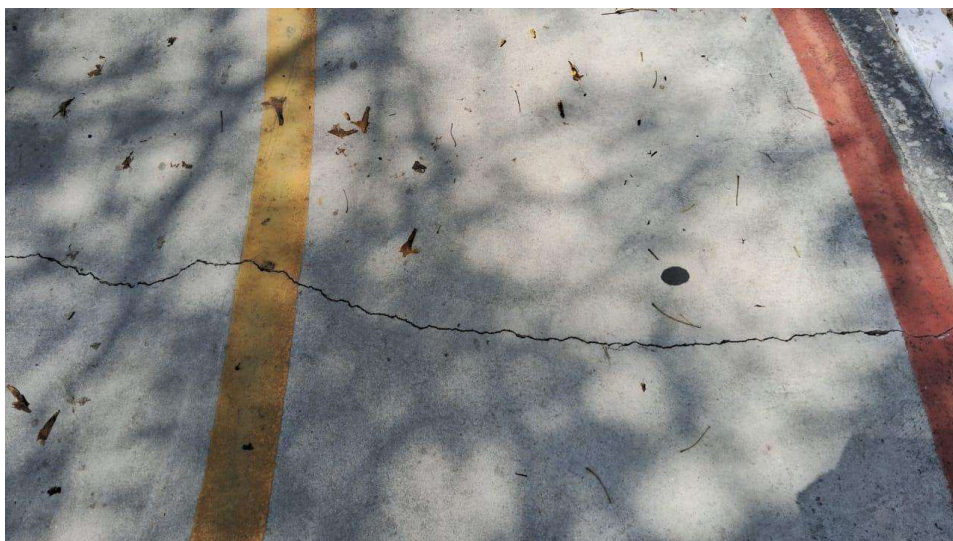
Figura 32 – Fissura longitudinal, possível falta de junta de dilatação.
