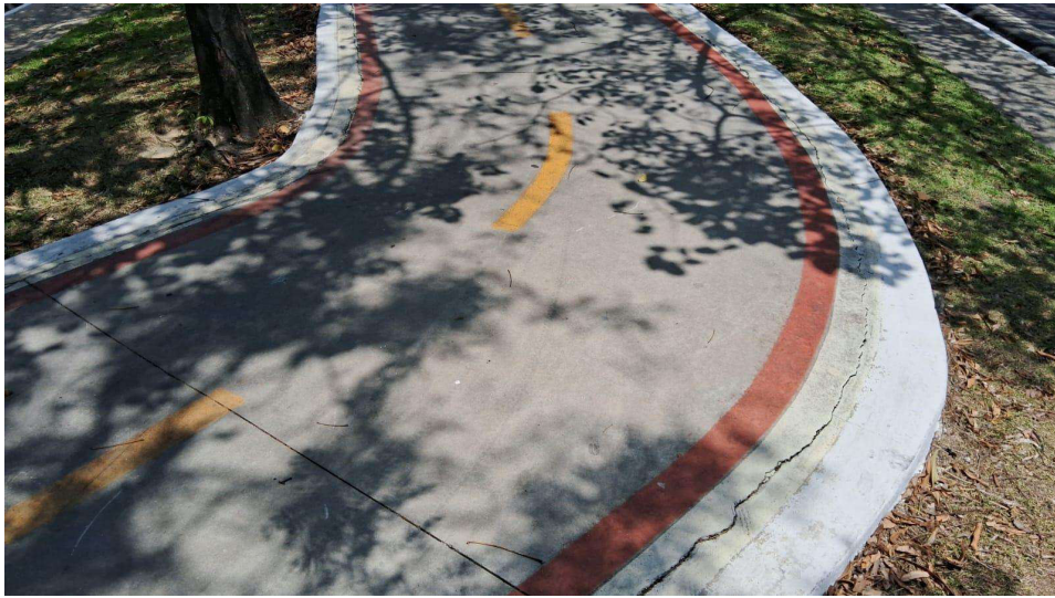
Figura 20 – Fissura longitudinal na ciclovia.
