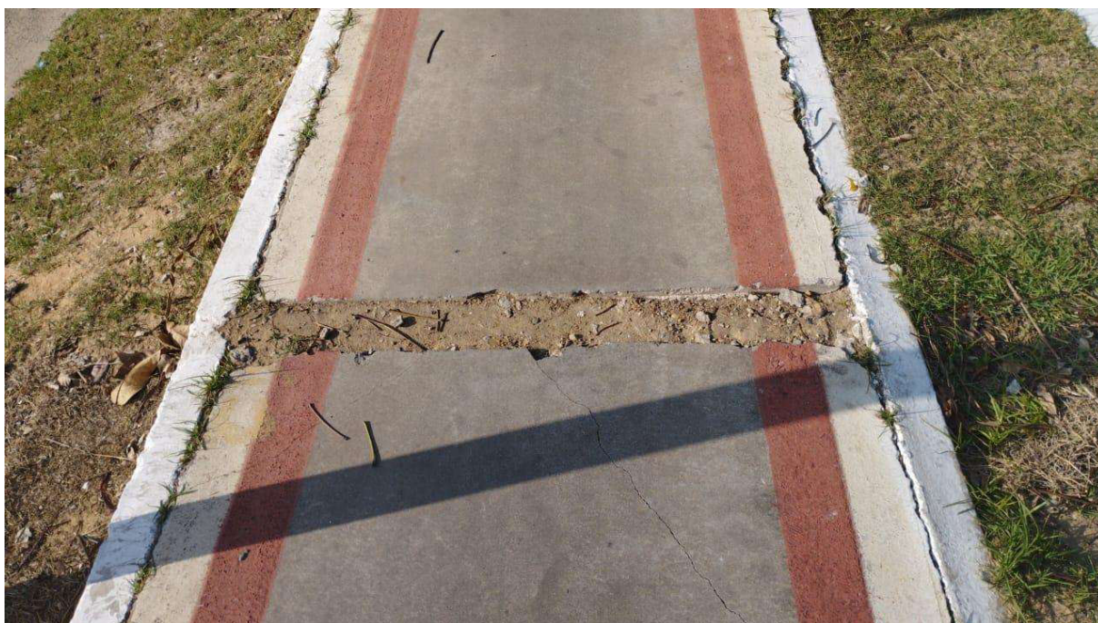
Figura 53 – Fissura diagonal e placa quebrada.
