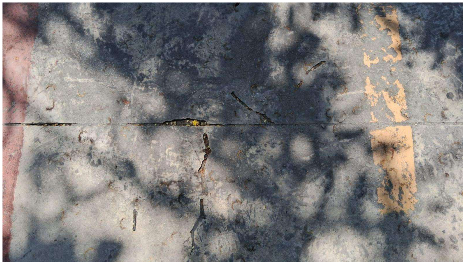
Figura 22 – Erro de execução na concretagem, elementos orgânicos no concreto.
