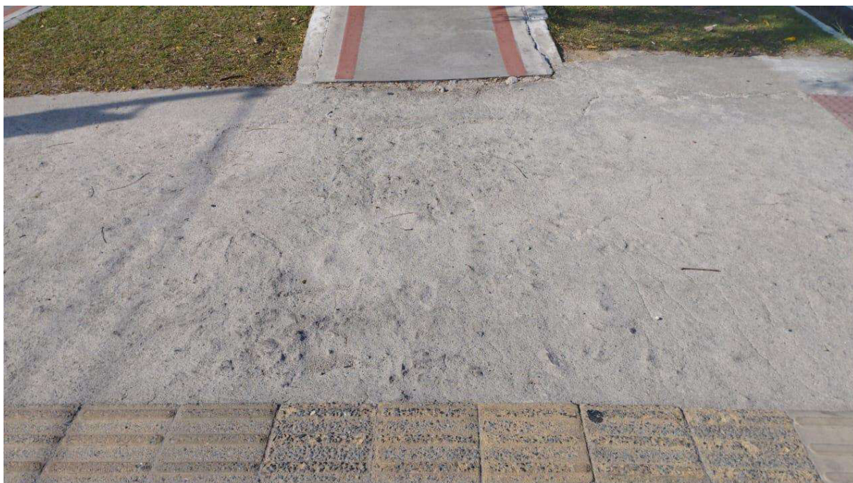
Figura 50 – Desgaste superficial de via.
