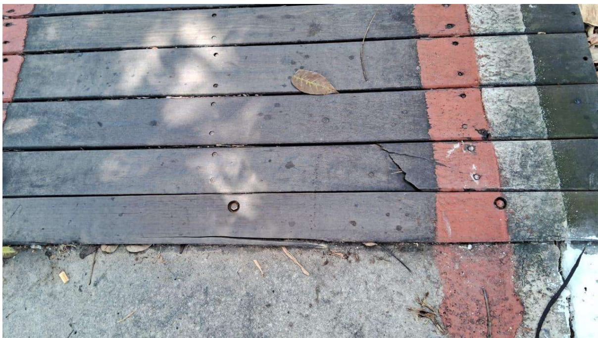
Figura 58 – perdas de parafusos e fissuras em estruturas de madeira.
