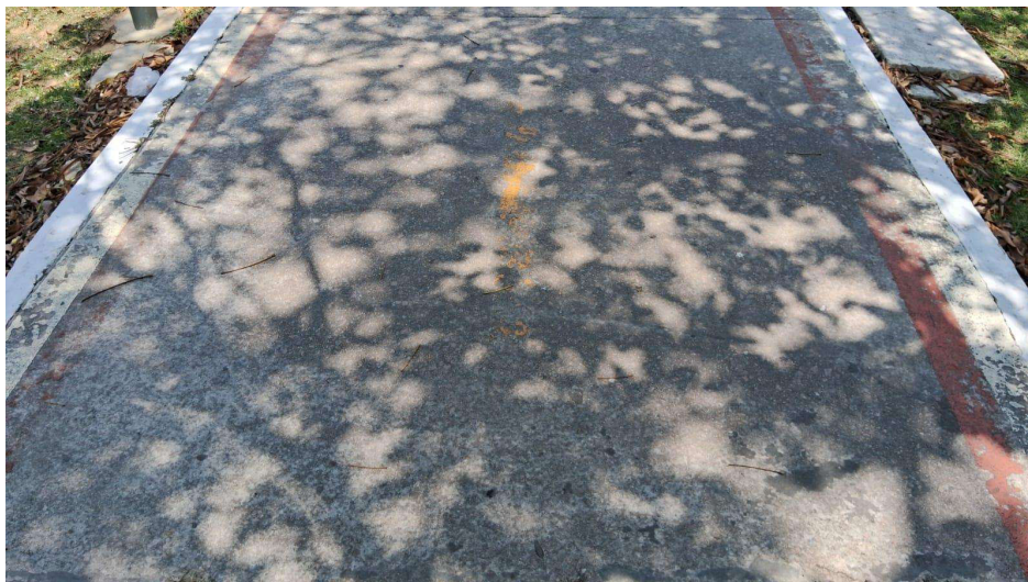
Figura 21 – Mau acabamento da placa de concreto.
