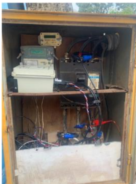
Figura 7 - Analisador de energia instalado no QGBT.
