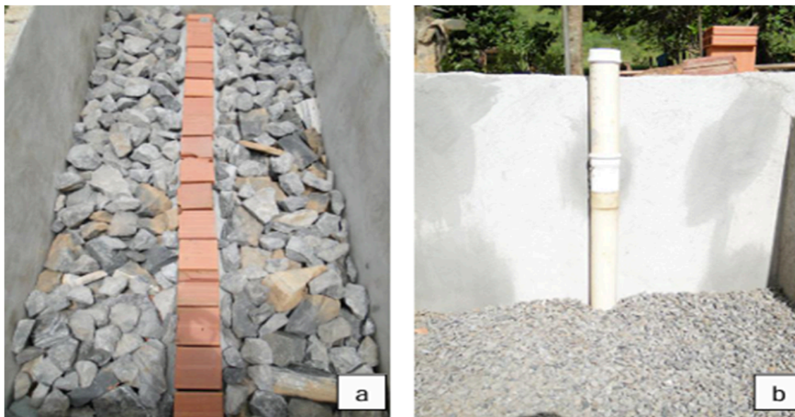
Figura 8 – Detalhes do meio suporte e tubulação de entrada de efluente na bacia de evapotranspiração
