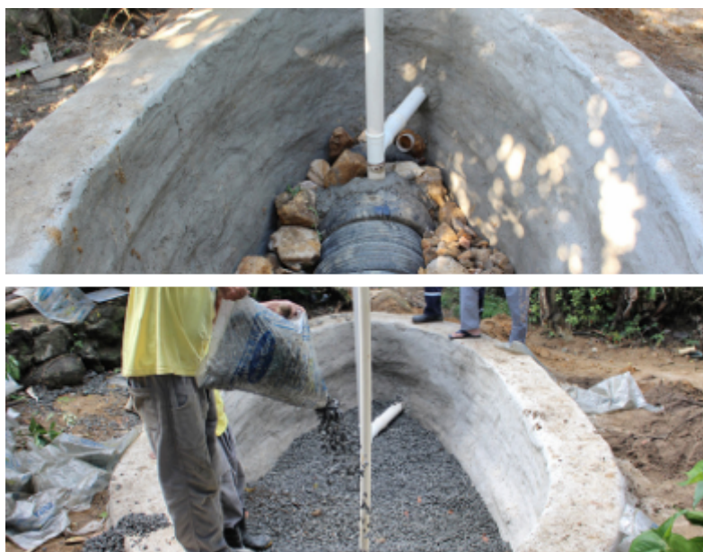
Figura 19 - Câmara de digestão anaeróbia e composição do meio suporte, evidenciando o formato oval
