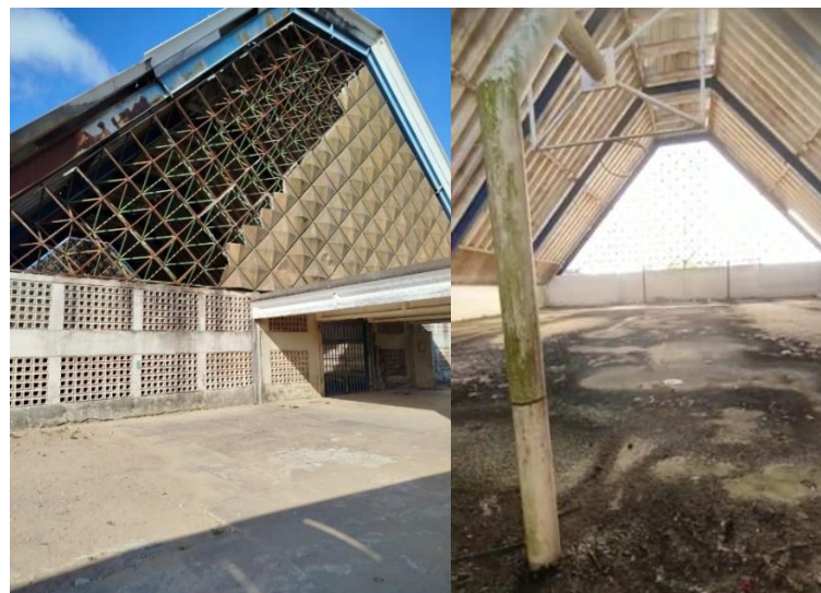
Figura 4. Vista externa e interna da quadra esportiva interditada.
