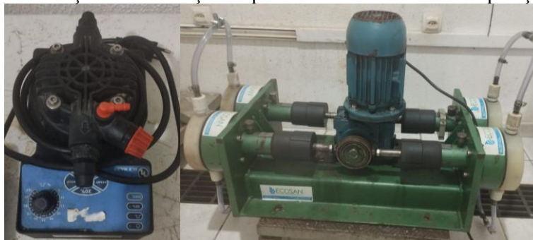
Figura 9: Bombas de alimentação e recirculação respectivamente utilizadas na operação dos reatores.
