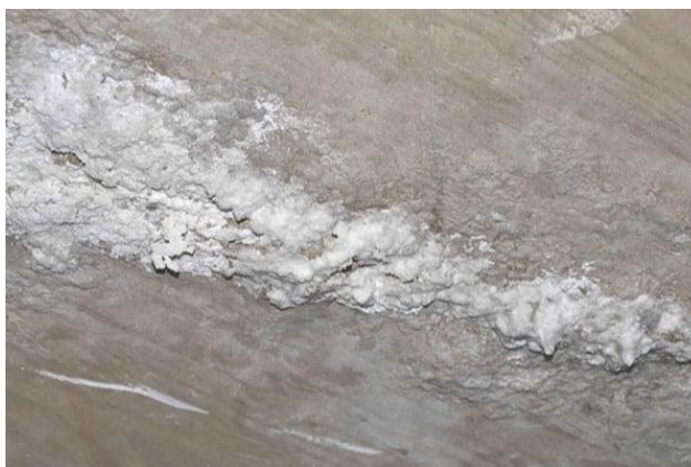
Figura 11 - Eflorescência decorrente da lixiviação
