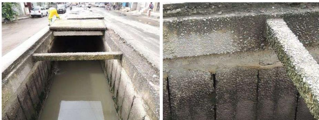
Figura 12 - Canal em concreto armado com a presença de ataque por sulfatos
