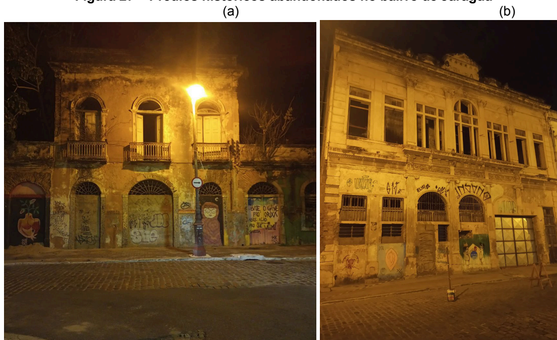
Figura 27 – Prédios históricos abandonados no bairro de Jaraguá
