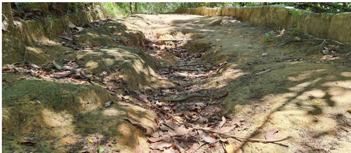
Figura 55 - Solo compactação, com a presença de sedimentos erodido – No Parque
