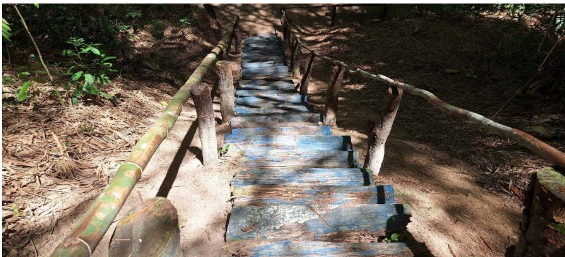
Figura 68 - Corrimão inadequado e escada deteriorada
