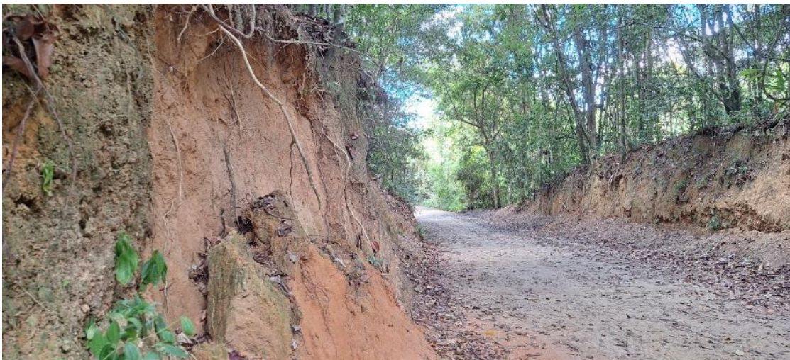
Figura 32 - Deslizamentos, com presença de rachaduras no solo – No Parque.
