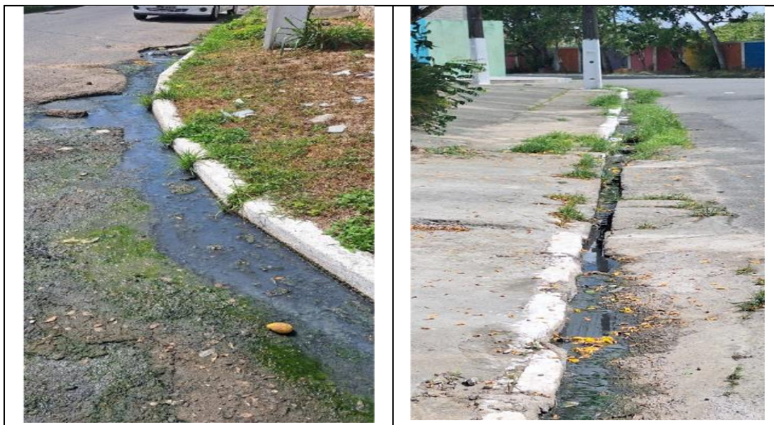
Figura 8 - Esgoto à céu aberto
