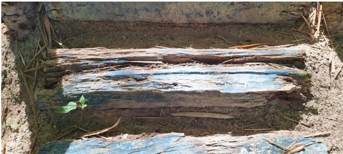
Figura 69 - Estrutura precária e falta da manutenção da escada
