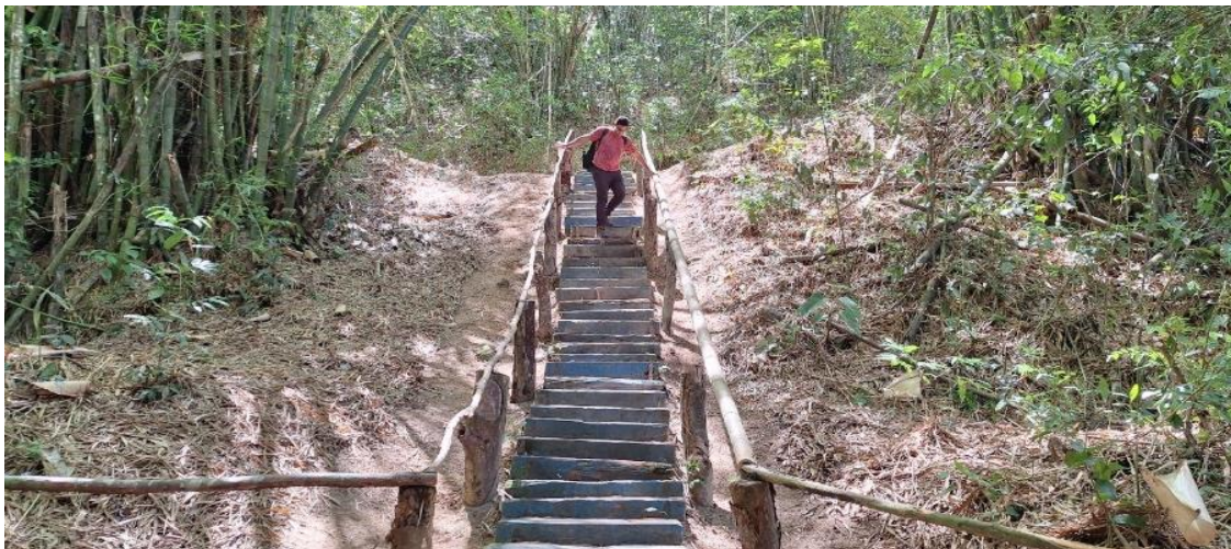
Figura 67 - Escada danificada no Parque
