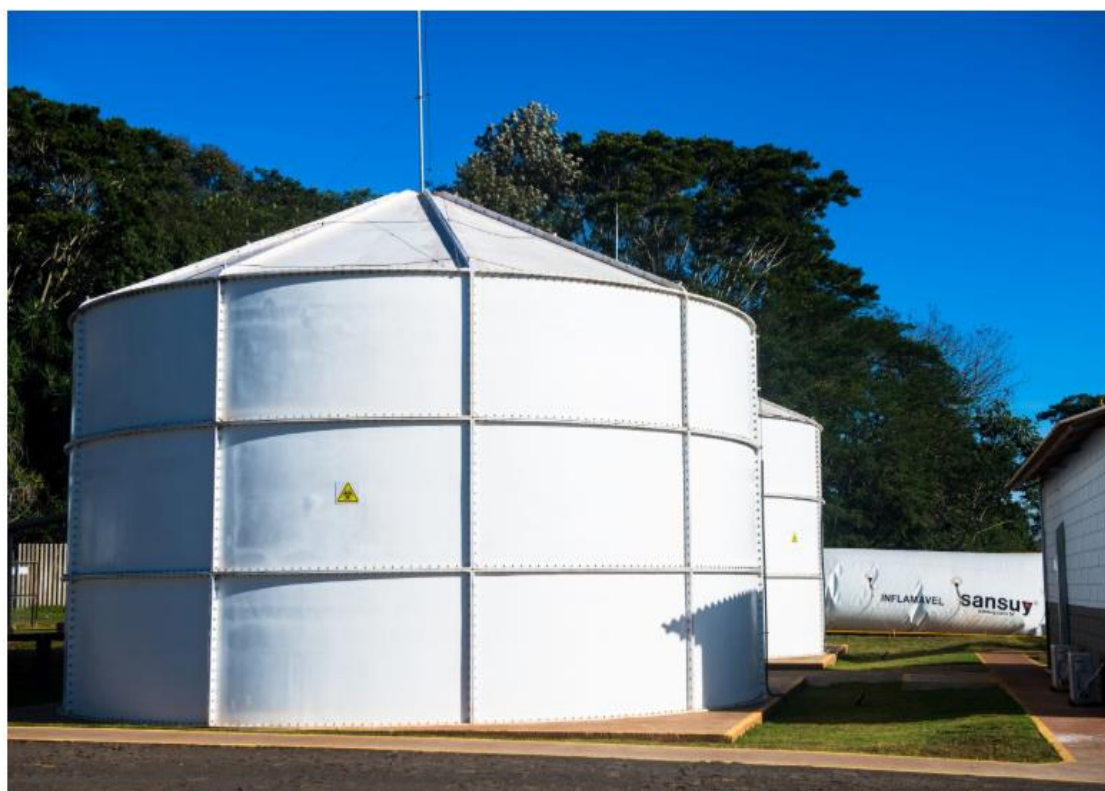
Figura 7- Biodigestor CSTR (Tanque de agitação contínua).
