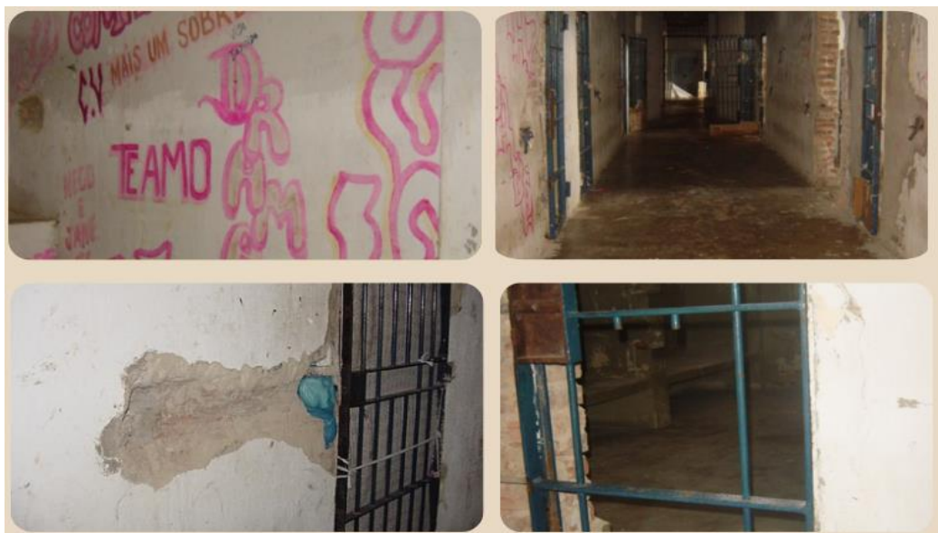
Figura 10 – Condições estruturais do antigo Prédio do NRC
