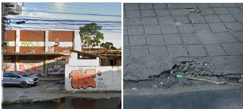
Figura 46: Imagem A e B com as paredes com propagandas, desenhos urbanos e esgoto exposto e detalhe da calçada.
