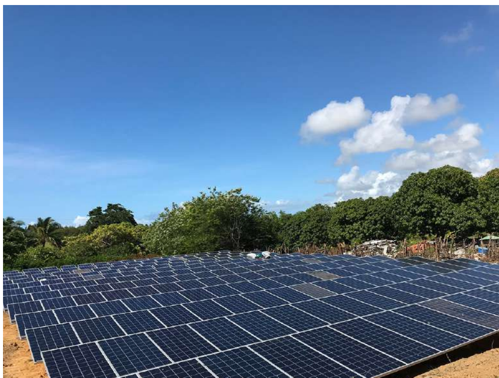
Figura 24: Painéis fotovoltaicos do Restaurante Divina Gula instalados na Barra de Santo Antônio/AL.
