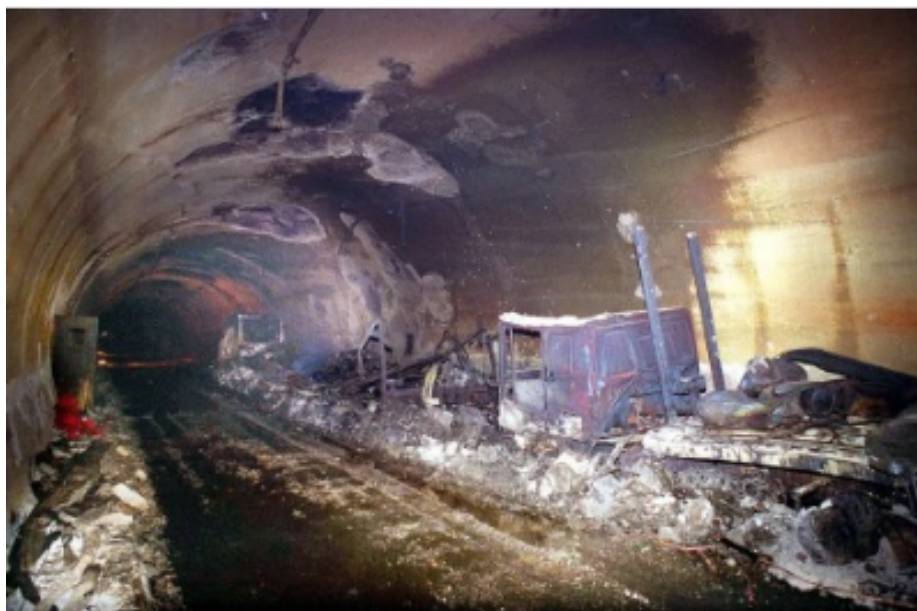
Figura 3 – Efeitos de estilhaçamento no teto do túnel Mont Blanc, induzidos por um incêndio que ocorreu em 1999.
