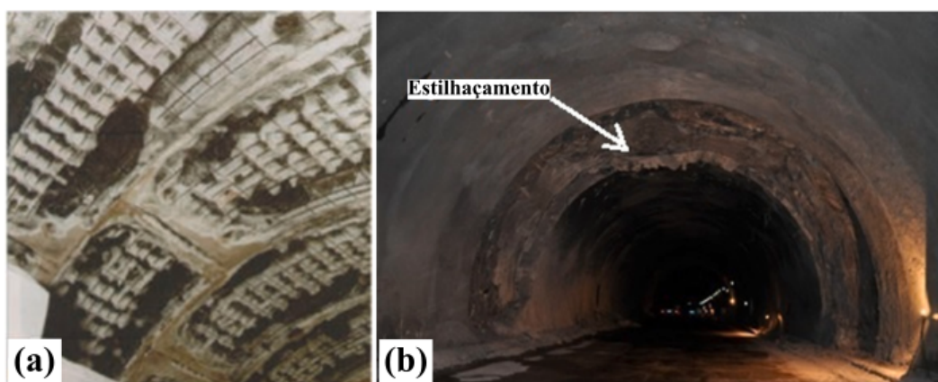
Figura 2 – Estilhaçamento nos revestimentos dos túneis após o incêndio (a) no Eurotunnel e (b) no túnel rodoviário de New Qidaoliang
