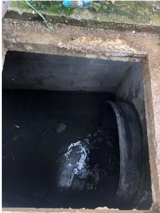
Figura 36 - Poço de visita com tubulação de 1000mm
