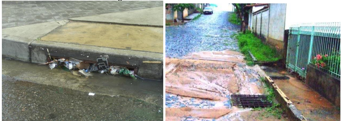
Figura 10 – Boca de Lobo
