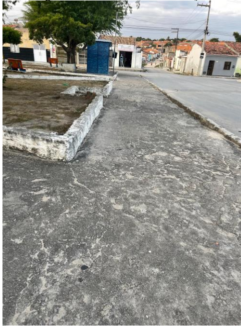
Figura 27– Piso sem manutenção.
