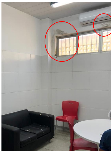
Figura 51 - Manchas de umidade na sala de descanso
