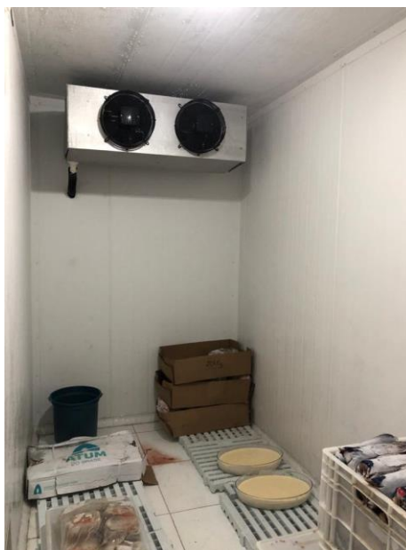
Figura 39 - Câmara frigorífica de carnes
