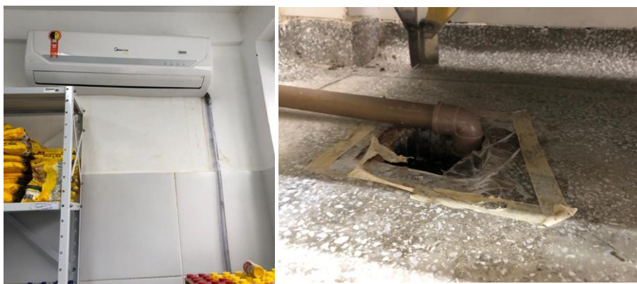
Figura 40 - Drenagem do ar-condicionado da sala de estoque
