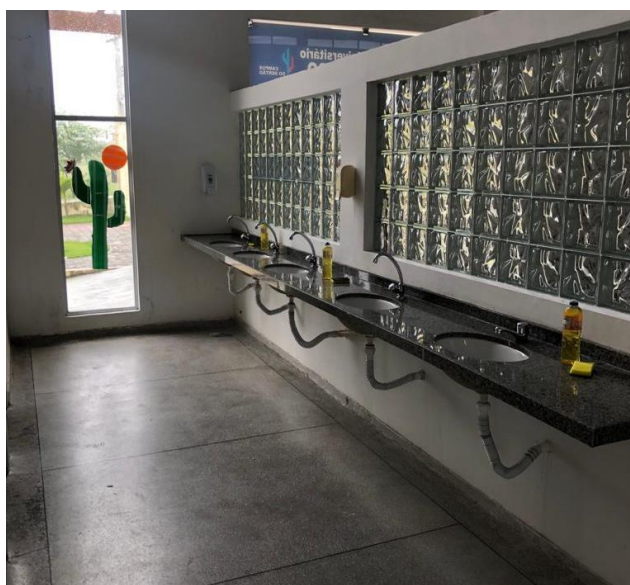
Figura 19 - Lavatórios de uso coletivo
