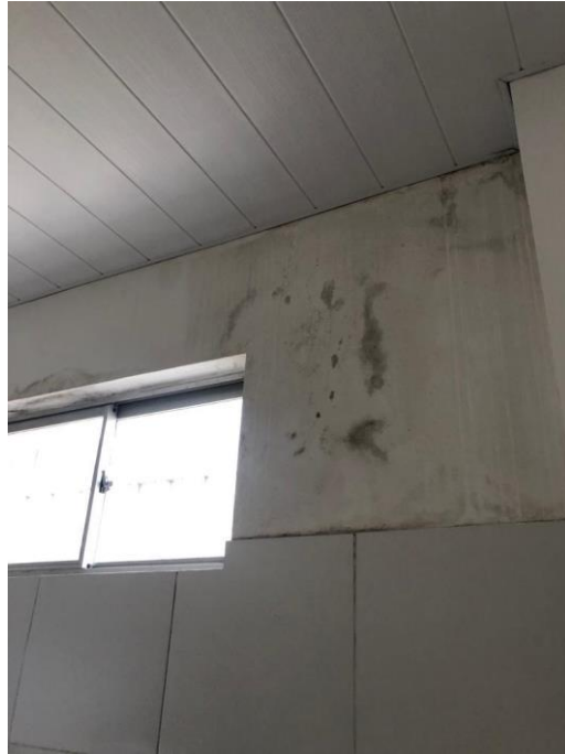
Figura 52 - Mancha de infiltração na cozinha experimental
