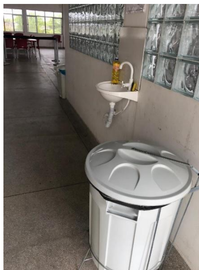
Figura 21 - - Lavatório do hall de entrada instalada posteriormente
