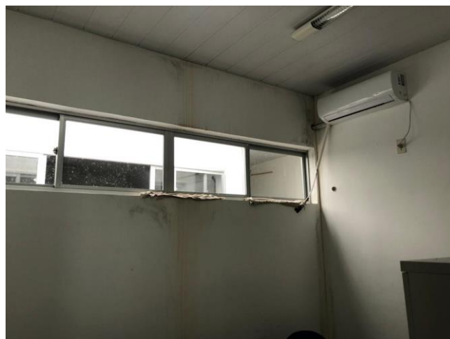
Figura 47 - Mancha de umidade devido a infiltração pelo forro PVC
