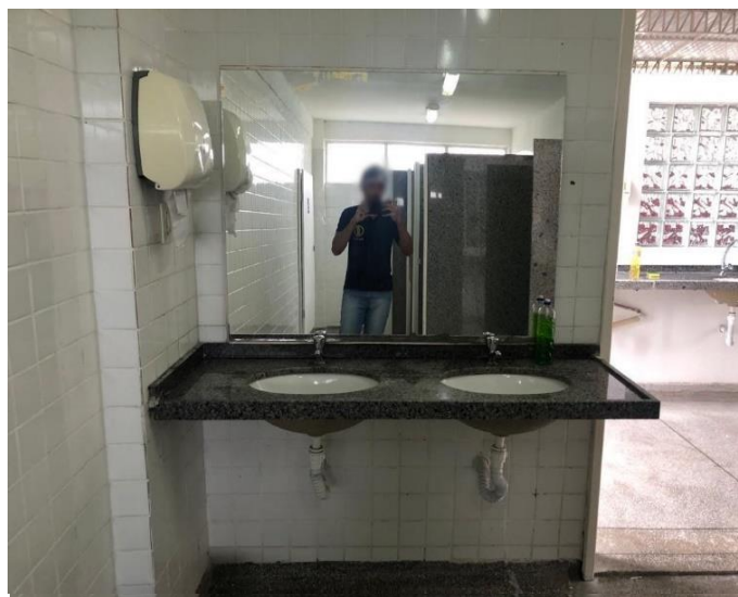
Figura 22 - Lavatórios do banheiro masculino
