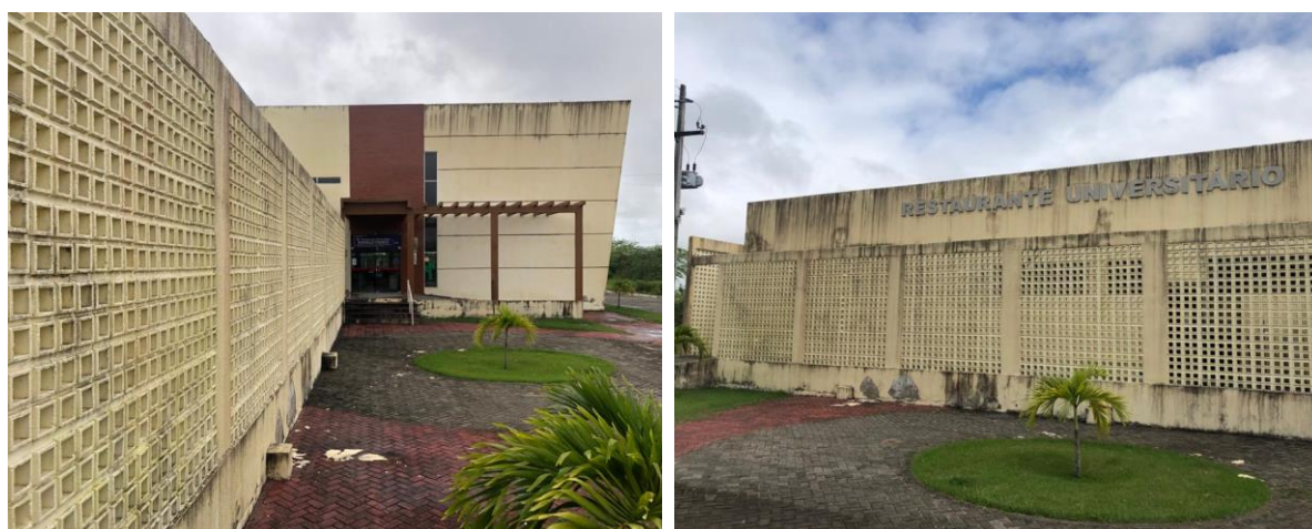
Figura 9 - Estado de conservação da fachada atualmente
