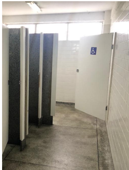
Figura 24 - Porta da cabine acessível do reservado masculino
