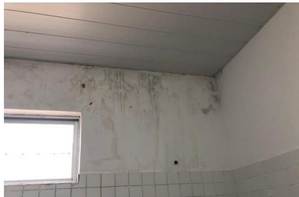
Figura 42 - Manchas de umidade no vestiário feminino
