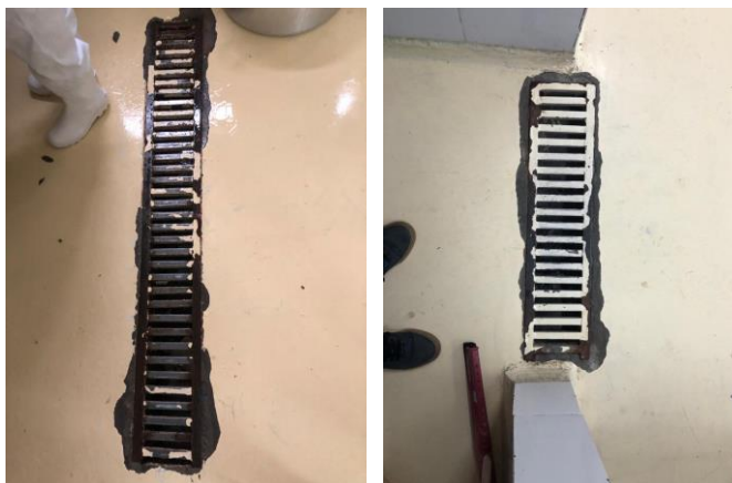
Figura 33 - Condição do piso em contato com a grelha
