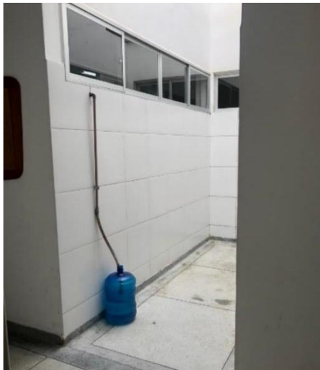
Figura 49 - Drenagem do ar-condicionado da sala da coordenadoria
