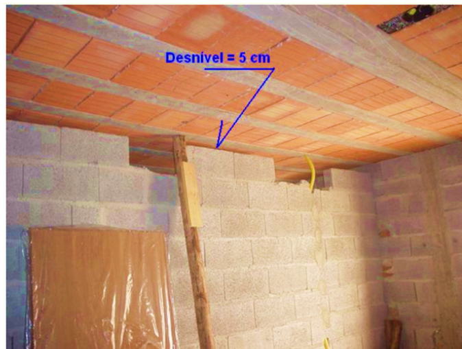
Figura 27: Laje com flecha acentuada.
