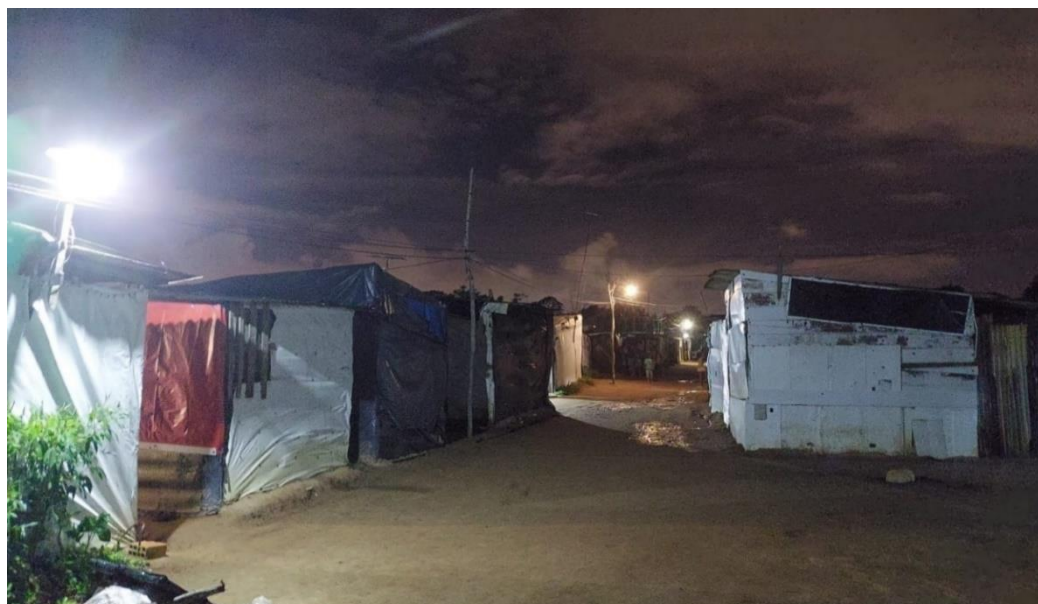
Figura 40 - Rede improvisada de iluminação pública da Ocupação Dandara.
