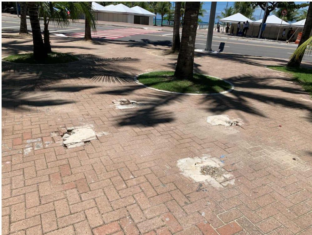
Figura 24 - Ponto de Análise E: área de circulação central da Praça, remoção inadequada das instalações natalinas.
