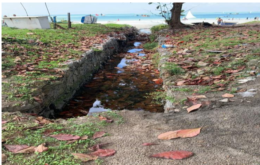
Figura 19: Galerias de águas pluviais.
