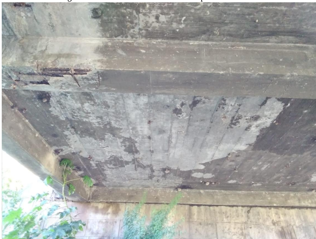
Figura A. 3 - Corrosão da armadura e deslocamento
