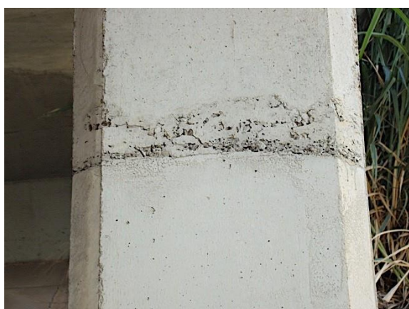
Figura 11: falha de concretagem ( F_i = 1 )
