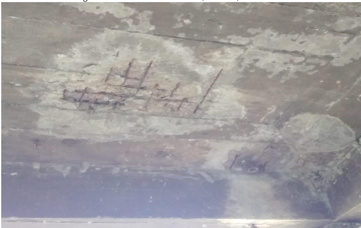
Figura A. 2 - Cobrimento deficiente, corrosão, eflorescência.
