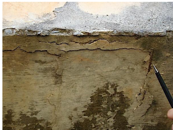
Figura 2: corrosão de armadura ( F_i = 3 )
