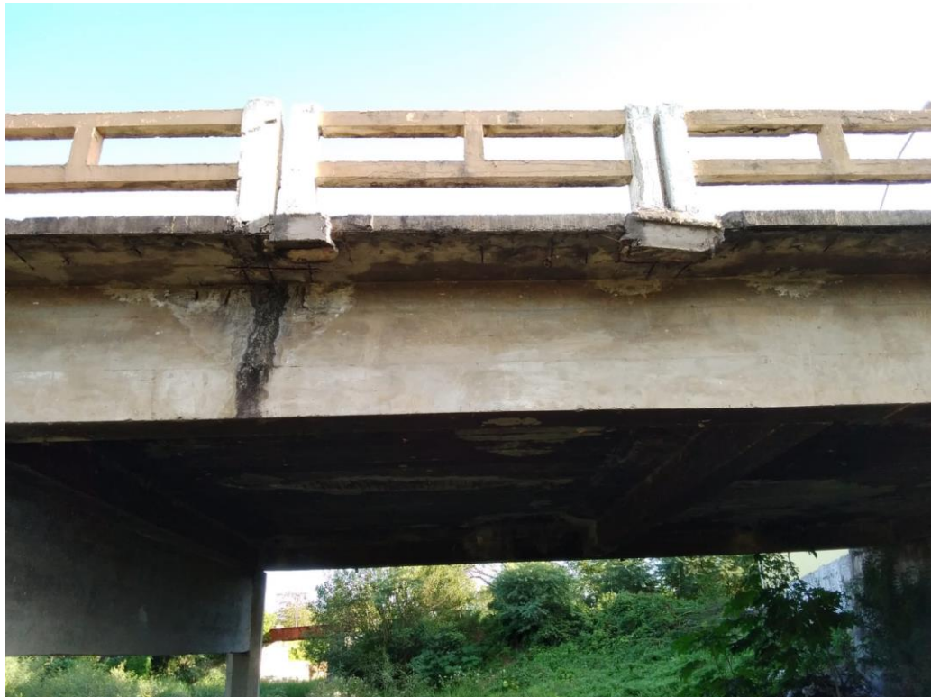
Figura A. 8 – Desplacamento, armadura exposta, eflorescência.
