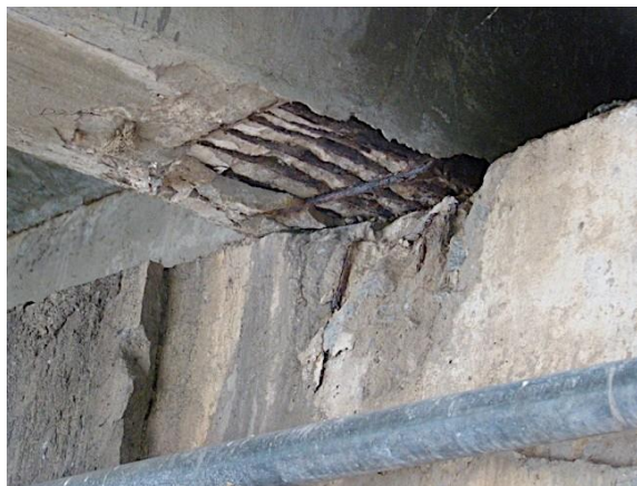
Figura 19: sinais de esmagamento do concreto ( F_i = 3 )
