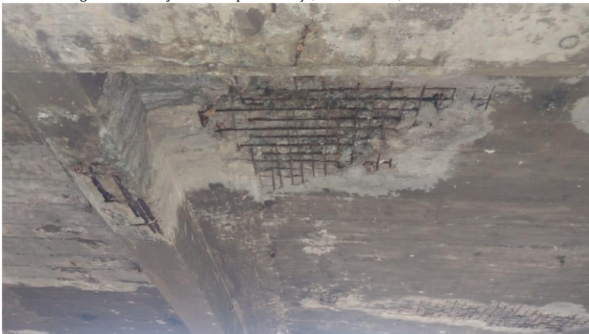
Figura A. 1 – Laje com alta perda de aço, eflorescência, cobrimento deficiente.
