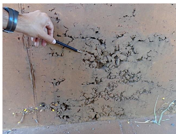
Figura 12: falha de concretagem ( F_i = 2 )
