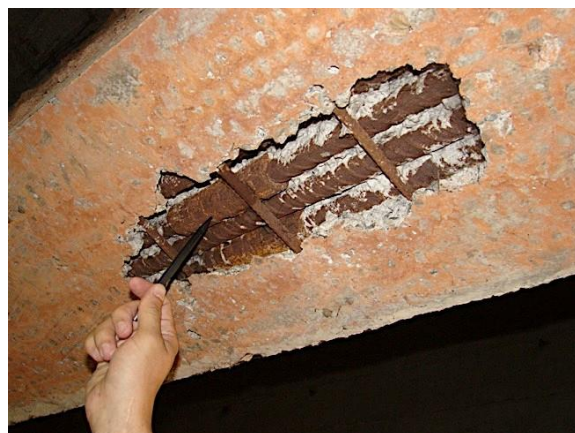
Figura 14: falha de concretagem ( F_i = 3 )
