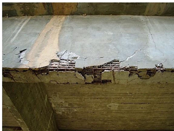
Figura 15: falha de concretagem ( F_i = 4 )
