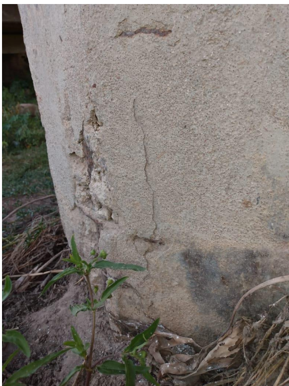
Figura 17 – Pilar c/ deslocamento.
