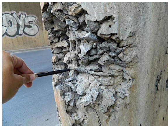
Figura 13: falha de concretagem ( F_i = 3 )
