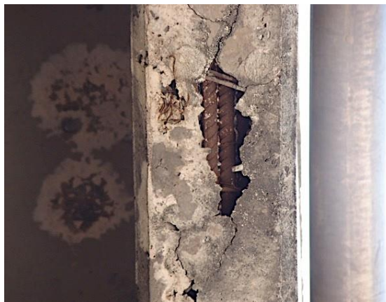
Figura 1: corrosão de armadura ( F_i = 2 )
