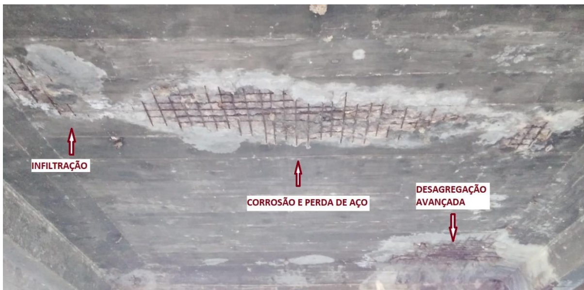
Figura 25 – Laje L1, cobrimento deficiente, eflorescência, manchas.
