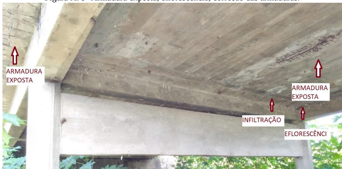
Figura A. 9 -Armadura exposta, eflorescência, corrosão das armaduras.
