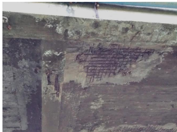
Figura 24 –Laje L1, armadura exposta.
