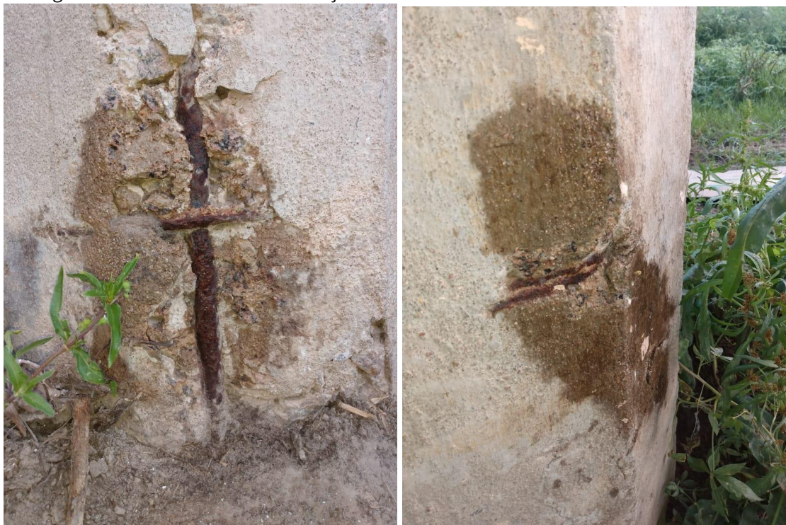
Figura A. 4 – Corrosão e carbonatação das armaduras com cobrimento deficiente.
