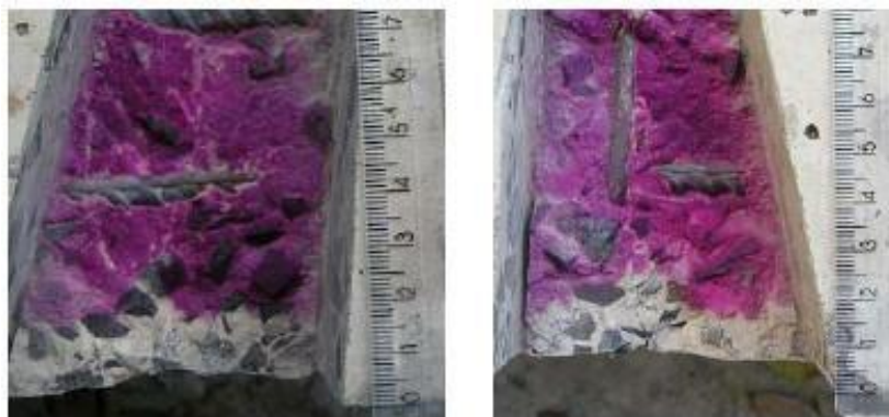
Figura 6 – Concreto carbonatado (teste com fenolftaleína)
