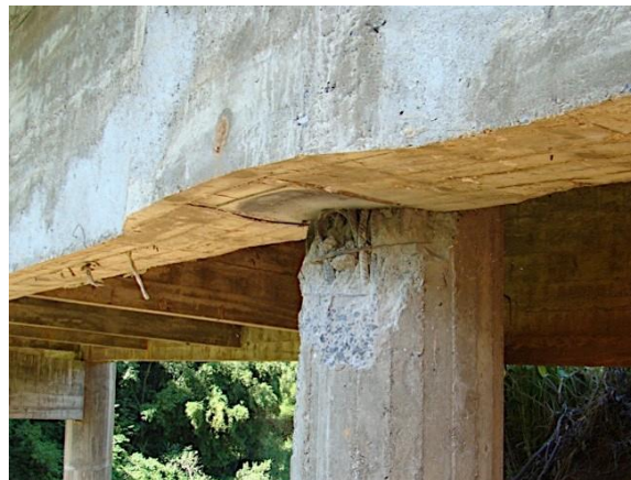
Figura 20: sinais de esmagamento do concreto ( F_i = 4 )
