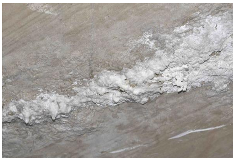
Figura 5 – Eflorescência sobre estrutura de concreto.
