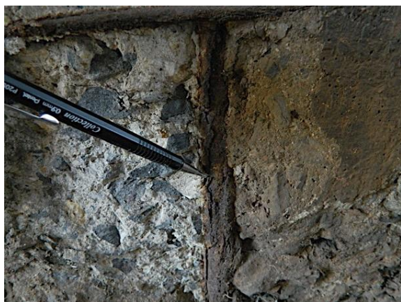
Figura 3: corrosão de armadura ( F_i = 4 )
