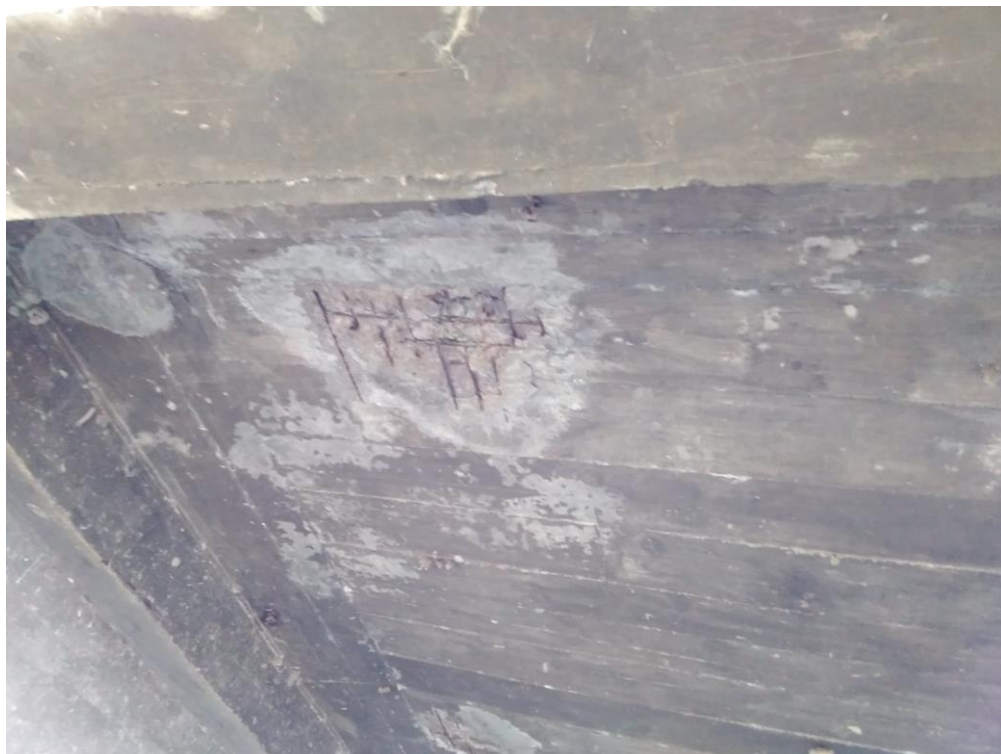
Figura A. 10 -Armadura exposta, eflorescência, corrosão das armaduras.
