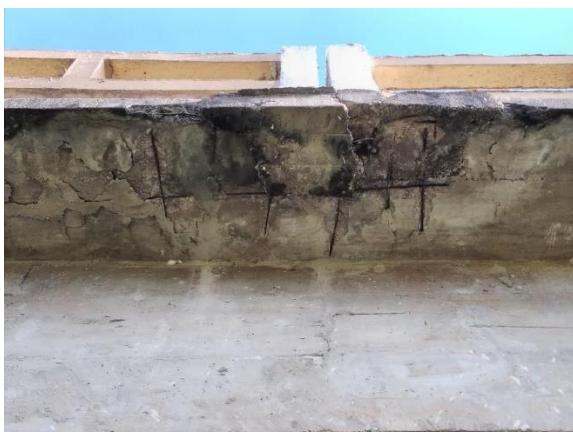
Figura 21 – Guarda-corpo c/ armadura exposta.
