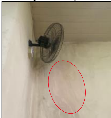
Figura 31 - Umidade por condensação no salão sacramental
