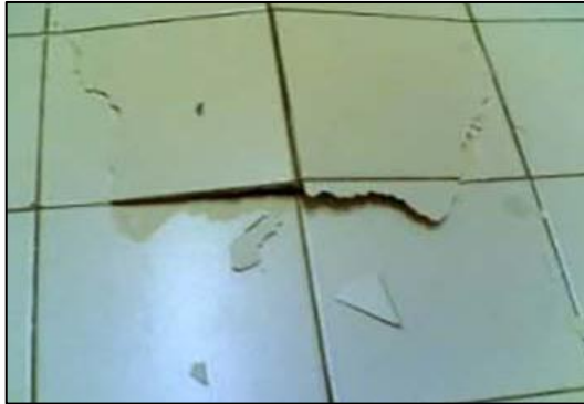
Figura 14 - Descolamento de uma placa de revestimento cerâmico.
