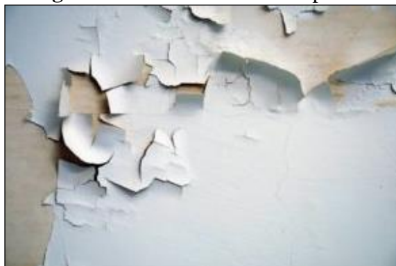
Figura 15 - Descascamento da pintura
