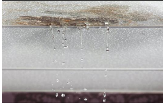
Figura 6 - Umidade por Infiltração
