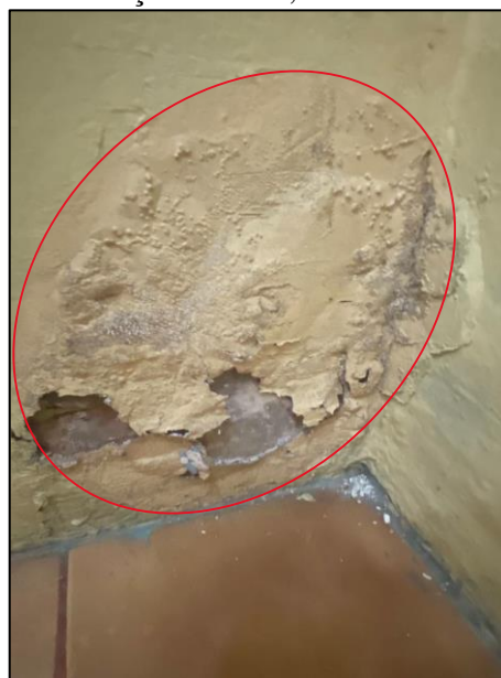
Figura 35 - Presença de mofo, bolor e bolhas na pintura
