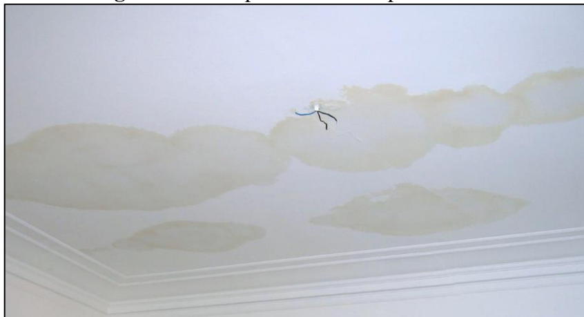
Figura 8 - Exemplo de manchas por umidade
