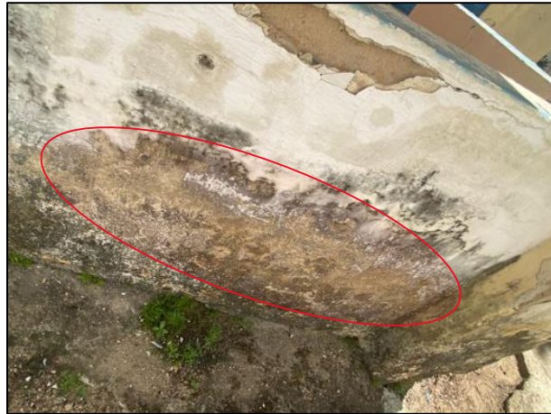
Figura 30 - Umidade por capilaridade na parte externa da varanda.
