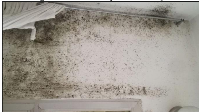
Figura 5 - Umidade por condensação
