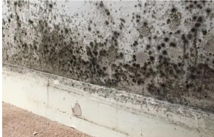
Figura 9 - Parede com presença de mofo.
