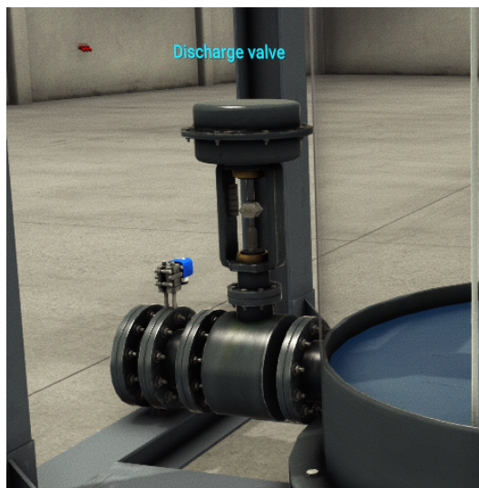
Figura 27 – Captura de tela da válvula de descarte do tanque.
