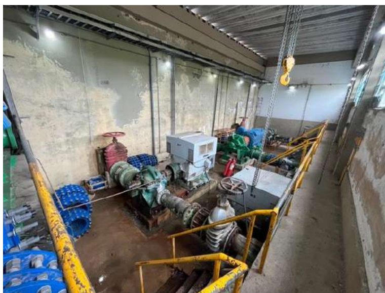
Figura 19 - Estação elevatória de água tratada 01 da Bacia Leiteira
