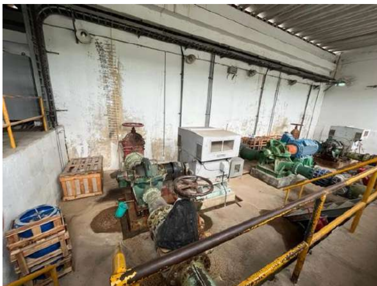
Figura 20 - Estação elevatória de água tratada 02 da Bacia Leiteira
