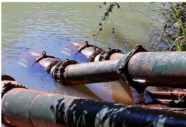
Figura 5 - Captação de água através de bombas anfíbias
