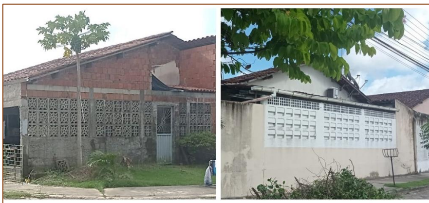
FIGURA 17: Casas com o uso de cobogós para obter ventilação e iluminação naturais.
